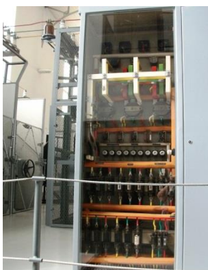
Figura 7 – Quadro elétrico. © Ana Paula Gonçalves
