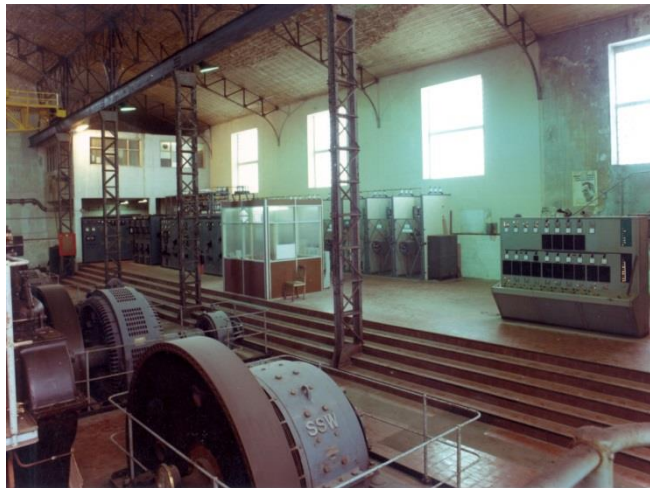
Figura 5 – Interior da Central a Diesel , distribuição elétrica (1990). Fonte: CDMIBdT
