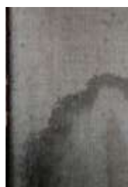
Figura 3.3. Mancha e linha de maré no verso. (F.C.)
