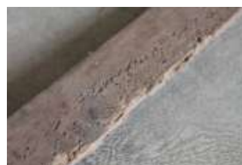
Figura 7. Zona da trave central degradada pelo ataque de xilófagos. (V.S.)
