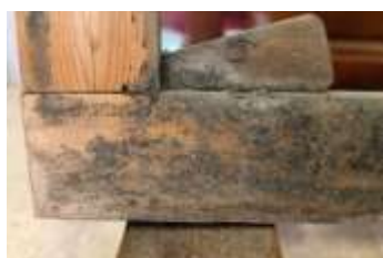
Figura 3.9. Canto com acumulação de sujidade e um pouco de podridão devido ao contacto com a água. (F.C.)
