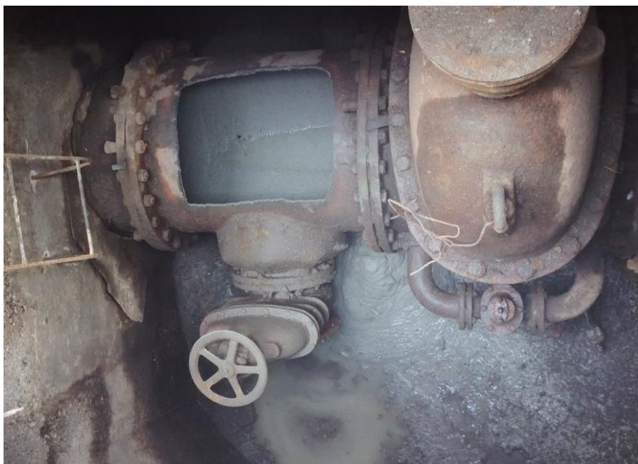
Figura 16 - Intervenção em conduta de aço com revestimento interior em betão projectado – aplicação da primeira camada (conduta e válvula datam aproximadamente de 1940 (Roménia 2014))
