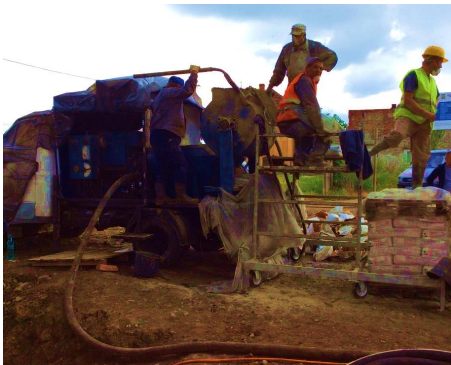
Figura 14 - Intervenção em conduta de aço com revestimento interior em betão projectado – Equipamento compressor (conduta e válvula datam aproximadamente de 1940 (Roménia 2014))
