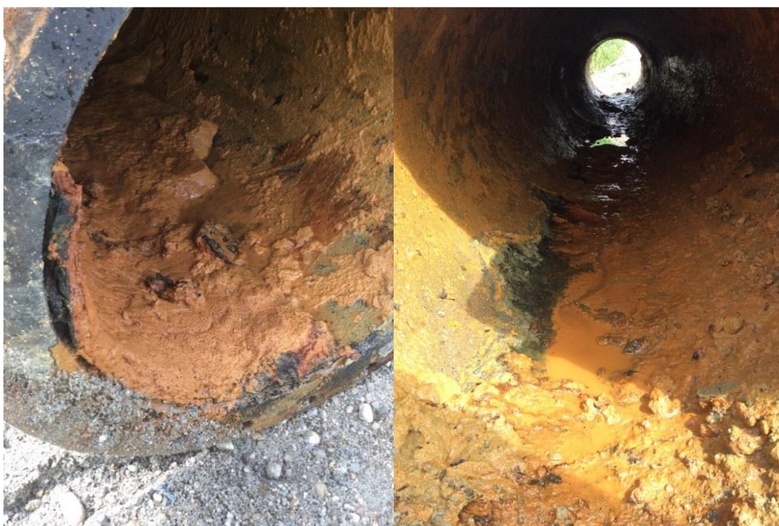
Figura 13 - Interior de conduta adutora em mau estado.
