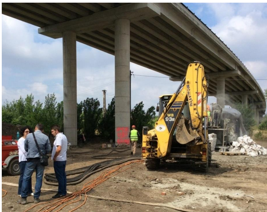
Figura 15 - Intervenção em conduta de aço com revestimento interior em betão projectado - Estaleiro (conduta e válvula datam aproximadamente de 1940 (Roménia 2014))
