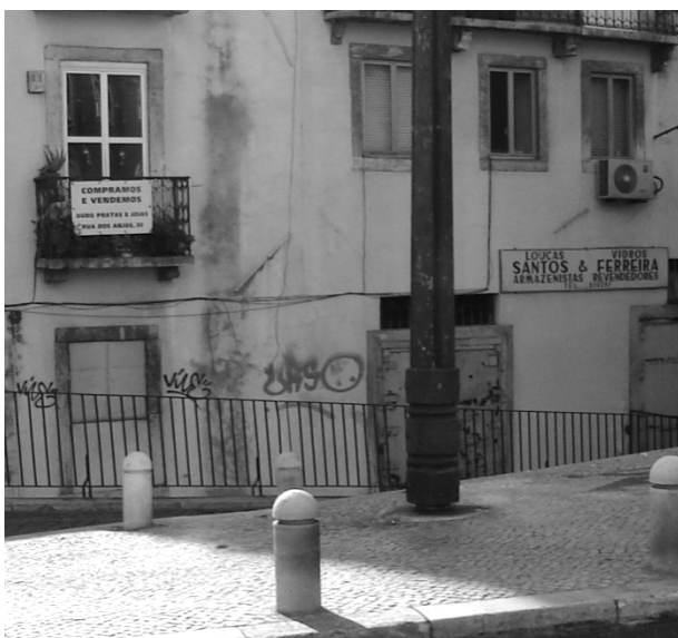
Ilustração 21 - Regueirão dos anjos - edifícios degradados, comércio abandonado
