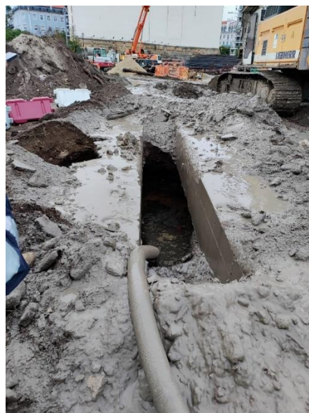
Figura 4.3 – Cavidade originada pelo colapso das paredes da escavação do painel 2A-31
