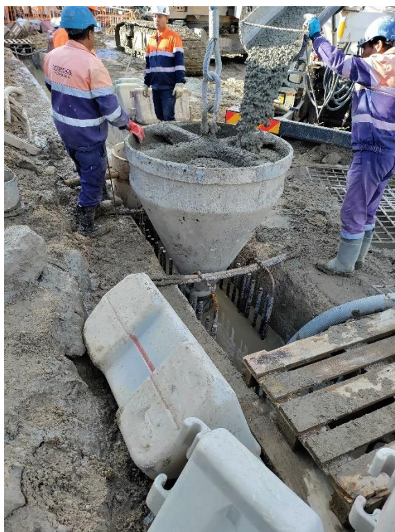
Figura 3.25 - Tremonha de receção de betão
