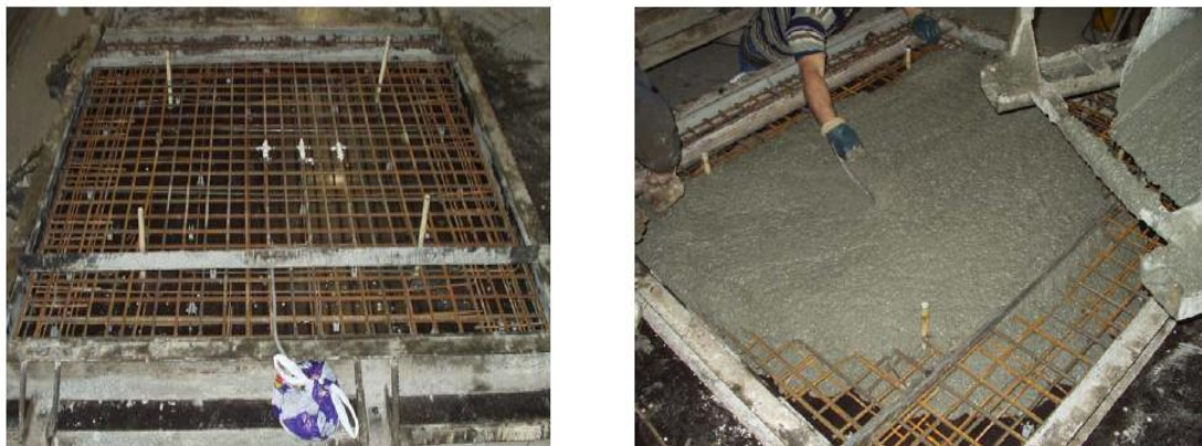
Figura 3.4 – Aspecto geral da armadura do modelo da laje antes e depois da betonagem.
