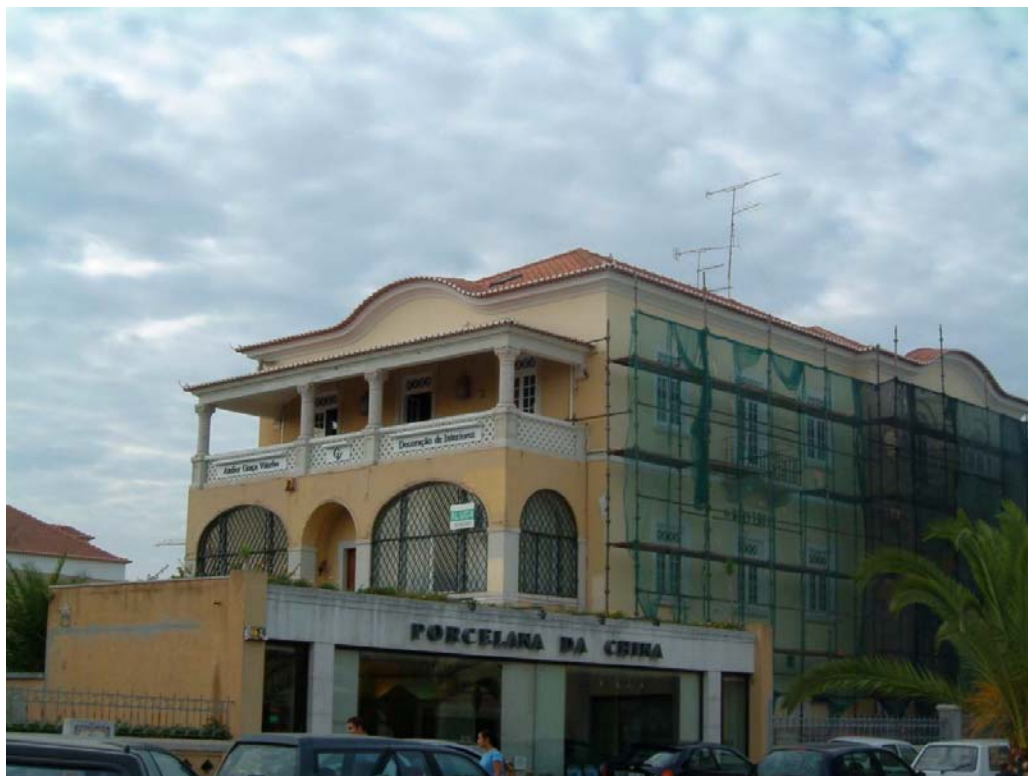
Figura 298 – Mesmo local, a casa de Camilo Farinhas, proj. eng. Jacinto dos Reis Betencourt, 1930 (fot. autora)
