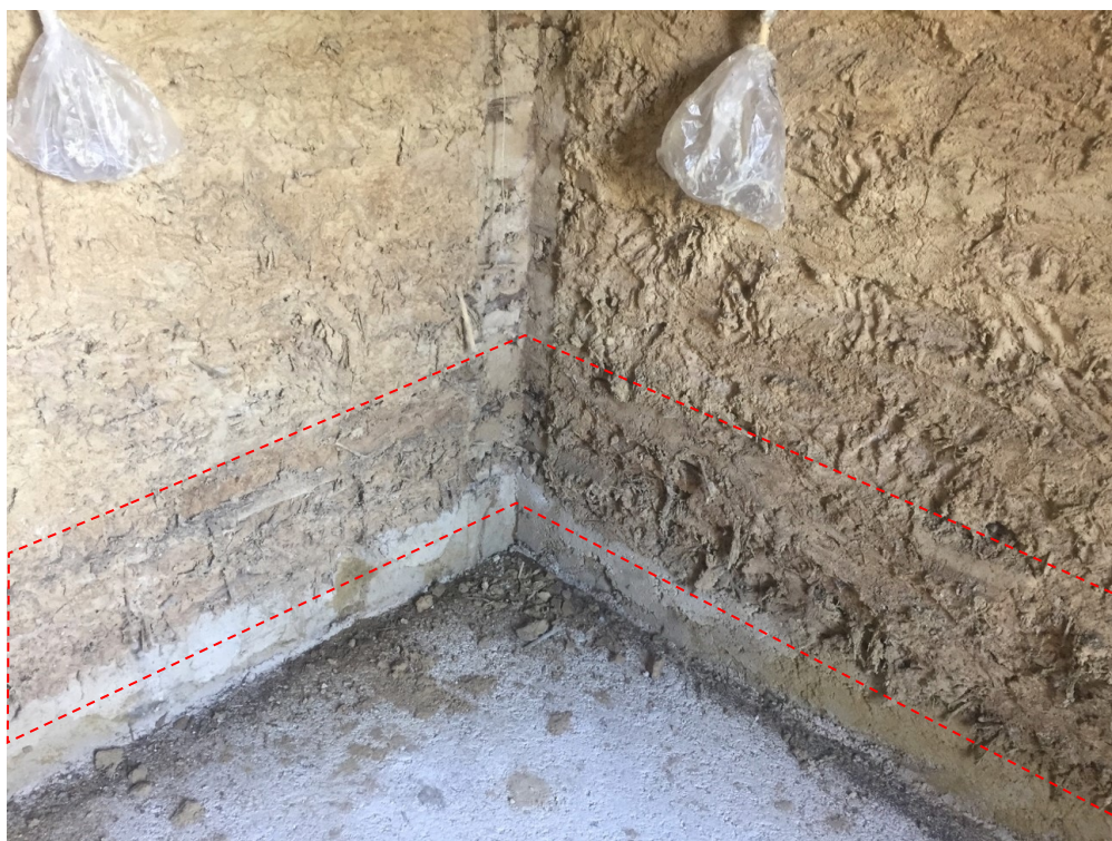
Figura 4.9-Mancha de humidade pertencente interior das paredes Oeste e Norte.
