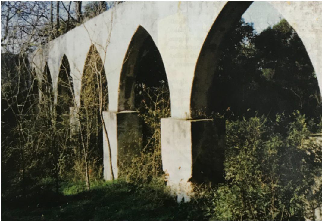
Figura 33. Aqueduto da Quinta da Princesa em 1997, demonstra como a estrutura vem tem seu estado de degradação acentuado. Lima, 1997.
