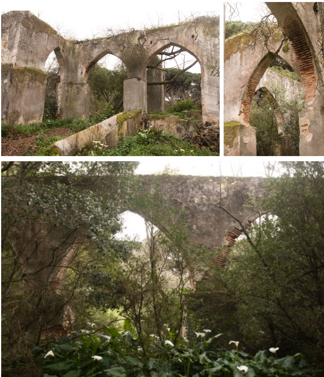
Figura 34. Aqueduto da Quinta da Princesa em degradação, sendo tomado pela mata. Autora, 2020.
