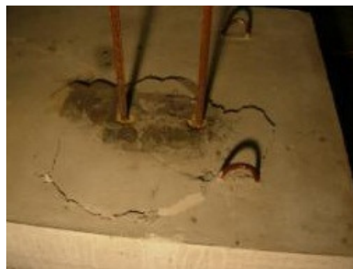
Figura 4.56 - Rotura pelo cone de betão
