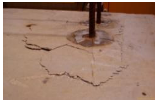
Figura 4.62 - Rotura pelo cone de betão
