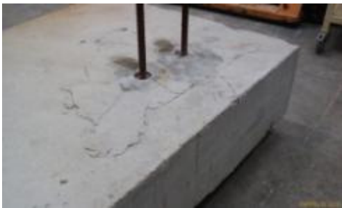
Figura 4.77 - Rotura pelo cone de betão
