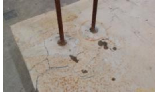
Figura 4.82 - Rotura pelo cone de betão
