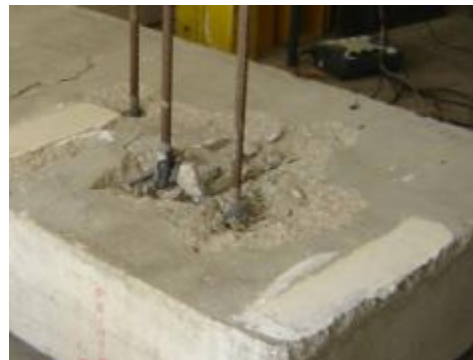
Figura 4.54 - Rotura pelo cone de betão
