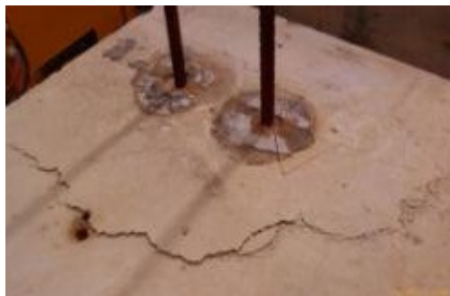
Figura 4.61 - Rotura pelo cone de betão
