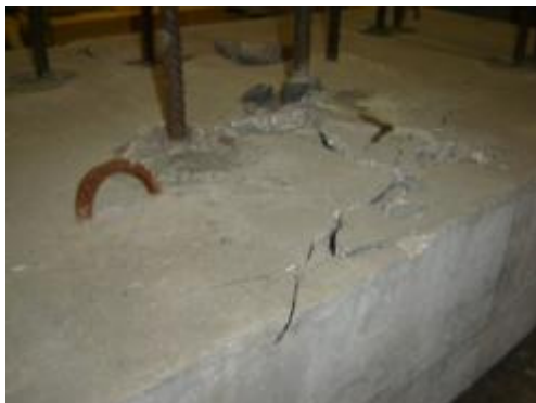
Figura 4.49 - Rotura pelo cone de betão
