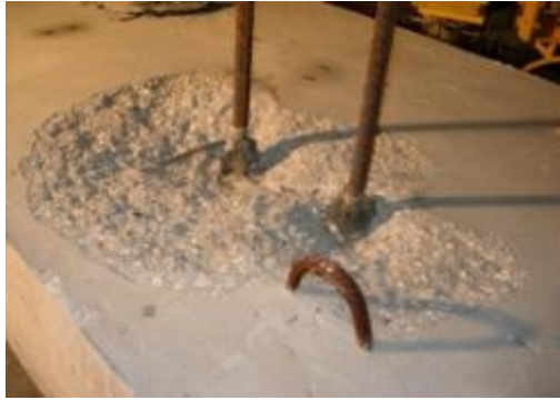
Figura 4.57 - Rotura pelo cone de betão
