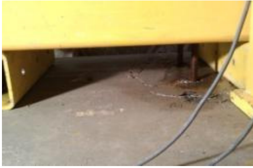
Figura 4.69 - Rotura pelo cone de betão
