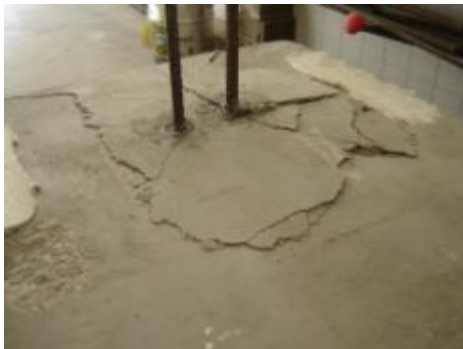
Figura 4.42 - Rotura pelo cone de betão
