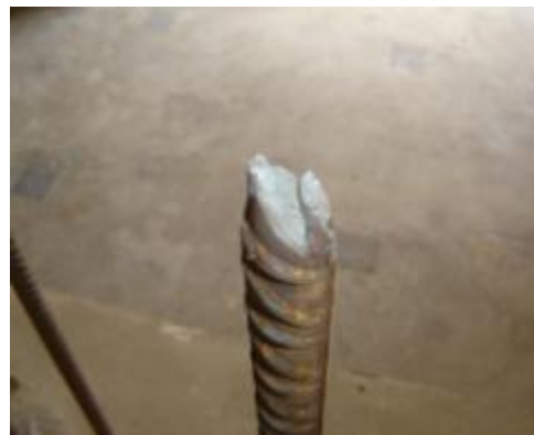
Figura 4.24 – Rotura pelo aço
