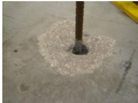
Figura 4.30 - Rotura por aderência
