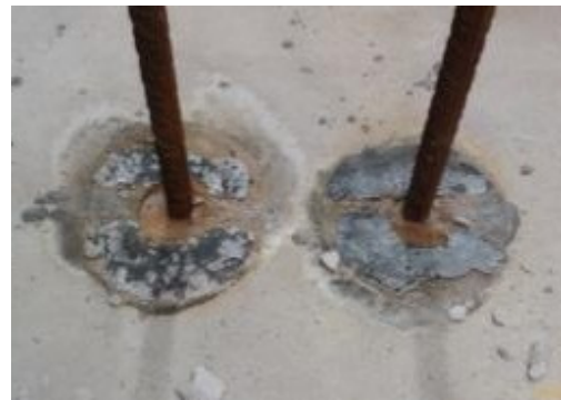
Figura 4.60 - Antes da rotura
