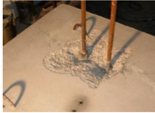
Figura 4.46 - Rotura pelo cone de betão
