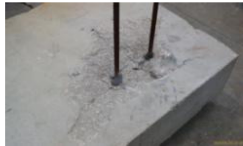
Figura 4.78 - Rotura pelo cone de betão
