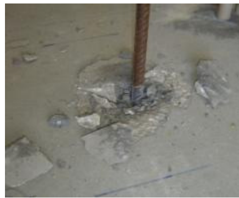
Figura 4.26 – Depois da rotura
