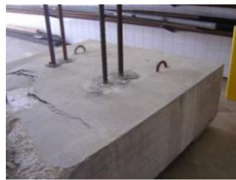
Figura 4.38 - Rotura pelo cone de betão
