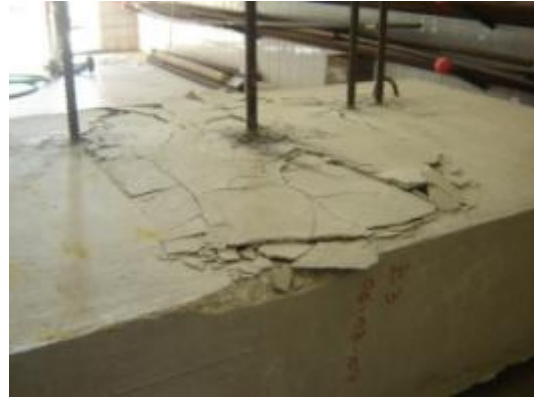
Figura 4.34 - Rotura pelo cone de betão
