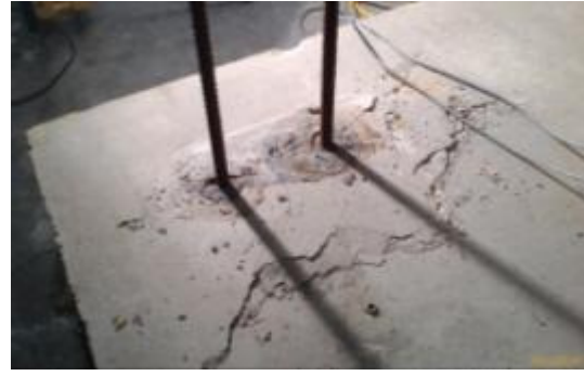
Figura 4.70 - Rotura pelo cone de betão
