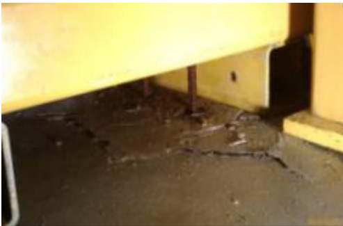
Figura 4.65 - Rotura pelo cone de betão
