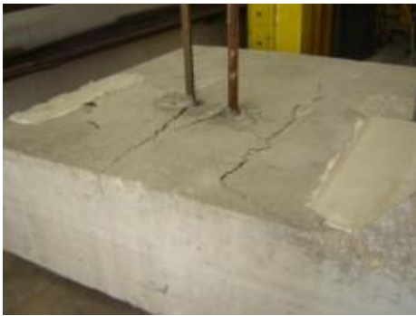
Figura 4.41 - Rotura pelo cone de betão
