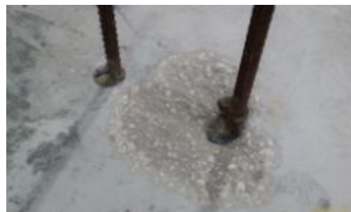
Figura 4.74 - Rotura por aderência
