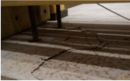
Figura 4.81 - Rotura pelo cone de betão
