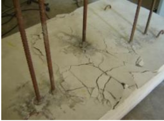
Figura 4.33 - Rotura pelo cone de betão
