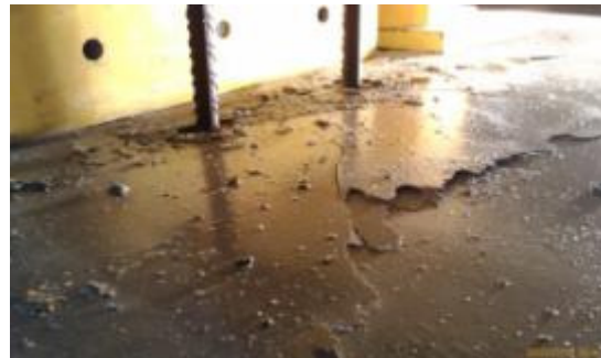
Figura 4.66 - Rotura pelo cone de betão
