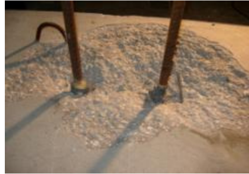
Figura 4.58 - Rotura pelo cone de betão
