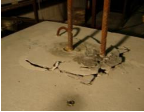
Figura 4.45 - Rotura pelo cone de betão
