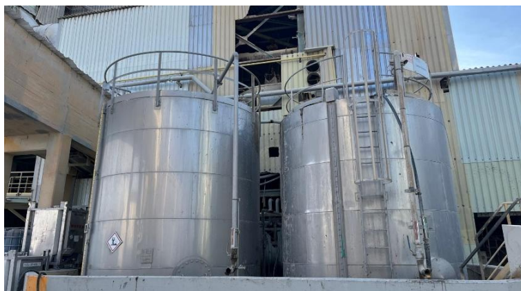
Figura 2.2- Depósitos que armazenam os revestimentos líquidos
