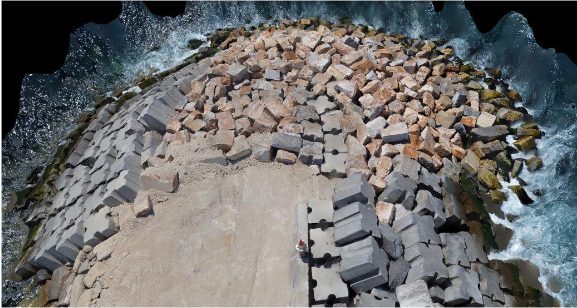
Figura 39. Detalhe da cabeça do molhe no modelo 3D no final da reabilitação
