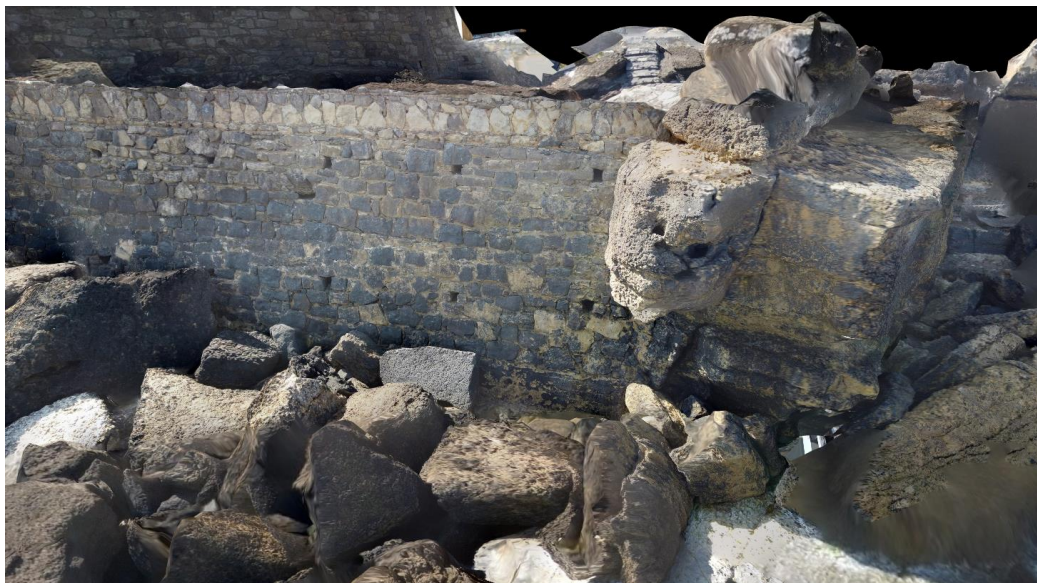
Figura 53. Extrato do modelo 3D da arriba onde aparece um bloco proeminente, em perigo de queda, no extremo sul da zona C.
