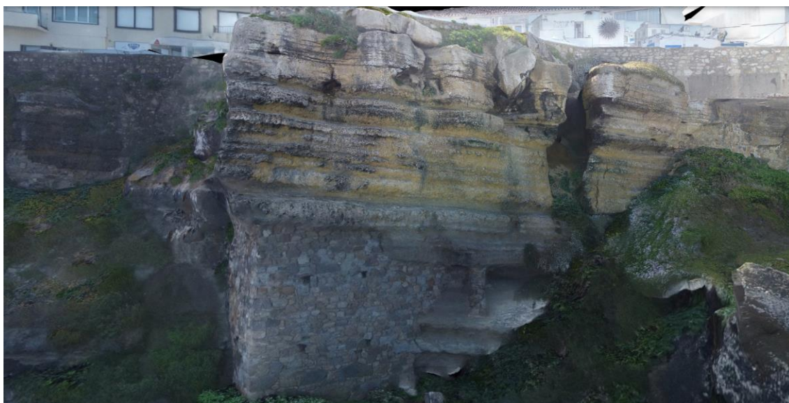
Figura 42. Base do talude com algumas obras de estabilização, nomeadamente a construção de uma base de alvenaria e pequeno pilar e cavidades de dissolução à direita.
