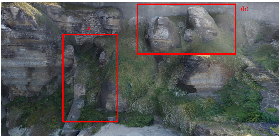
Figura 46. Existência de locas profundas, por fenómenos de erosão interna, e blocos potencialmente instáveis na zona B da arriba.
