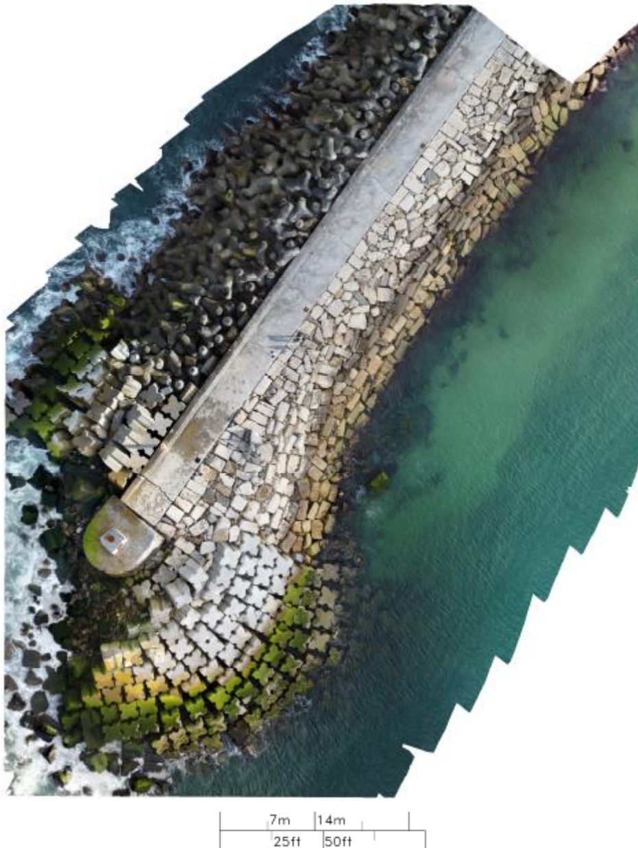
Figura 23. Ortomosaico da cabeça do molhe, sem oclusões, onde se detectam o colapso do setor da cabeça voltado para o mar, tetrápodes partidos, blocos de betão tombados, rotação da base da zona do farolim e fendilhamento na zona estreita do coroamento.
