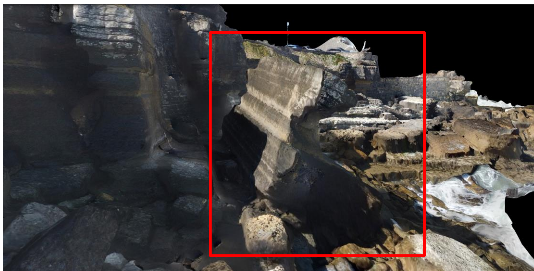
Figura 50. Aspecto de bloco, destacado em vermelho, em perigo de tombamento na zona C.
