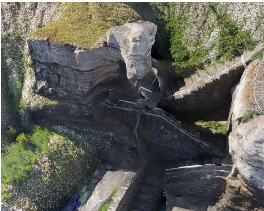
Figura 47. Bloco em risco de queda – visto em 3D.
