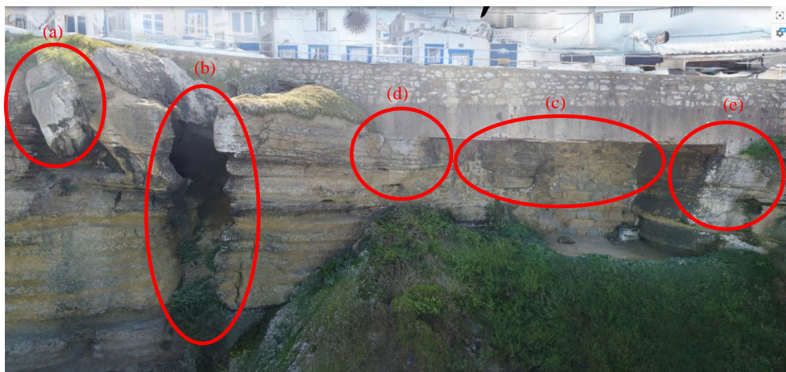
Figura 41. Ampliação do modelo 3D dos taludes, onde se destaca a formação de locas e a potencial precariedade da estabilidade do muro de alvenaria.
