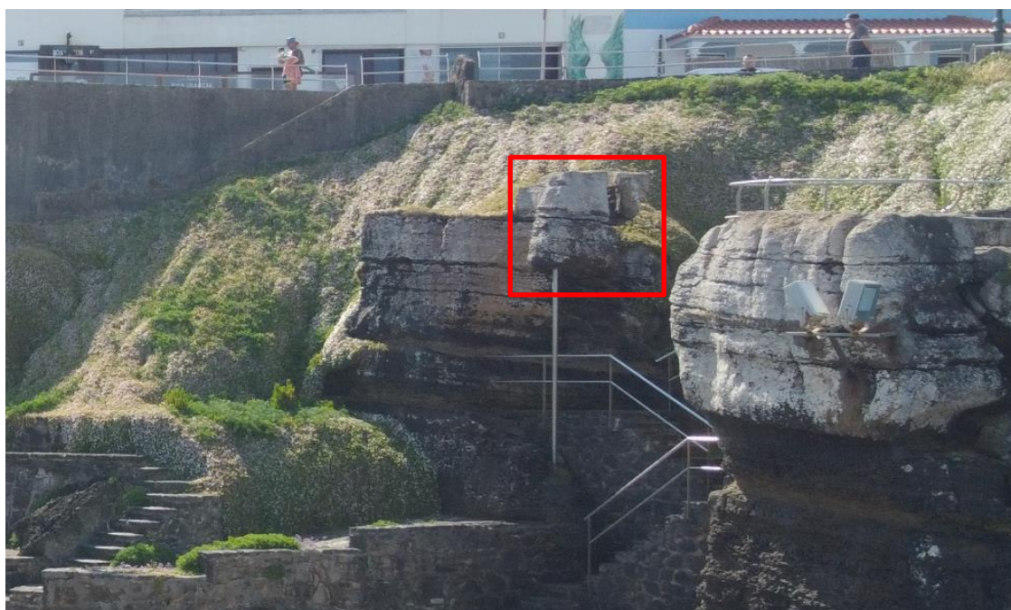
Figura 48. Imagem aérea de bloco assinalado em vermelho, em perigo elevado de queda, com destaque para a estrutura de suporte, junto à escadaria.
