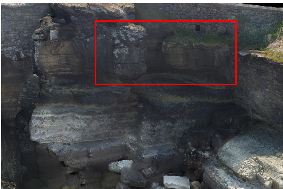
Figura 51. Aspeto da erosão diferencial e descalce significativo que colocam blocos (em vermelho) em balanço na parte superior da arriba na zona C.
