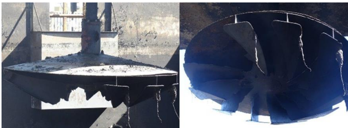
Figura 4.1 Estado atual dos arejadores de SJT.
