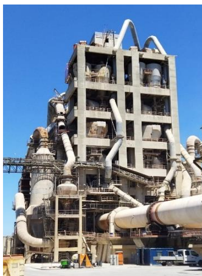
Figura 2.1 - Parte do forno e o conjunto da Torre de Ciclones na Fábrica de Maceira e Pataias
