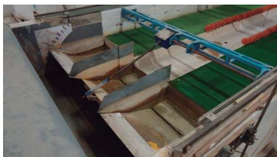
(d) Sistema de comportas no fim do canal
