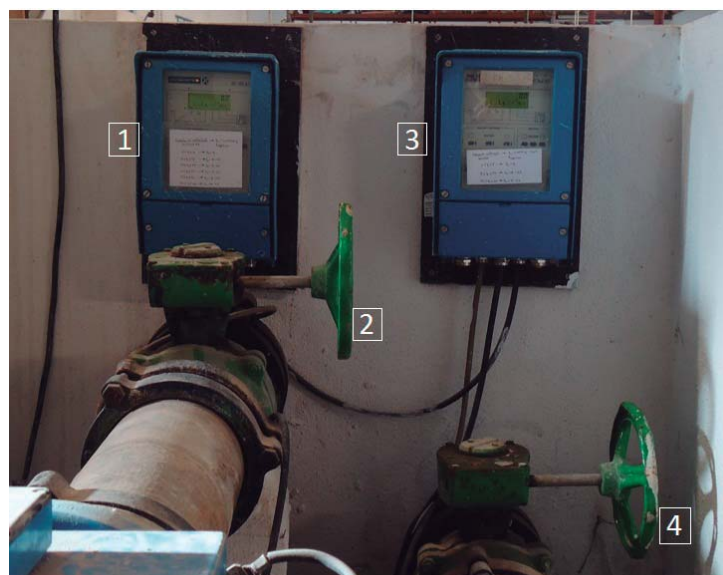
1 - Medidor de caudal dos leitos de cheia 3 - Medidor de caudal do leito principal 2 - Válvula de seccionamento dos leitos de cheia 4 - Válvula de seccionamento do leito principal
