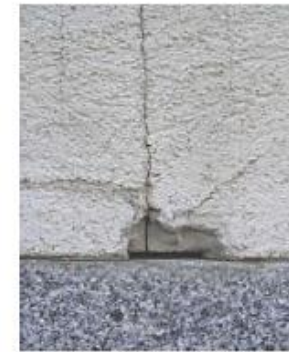
Fotog.4 - Zona de junta do perfil de arranque sem armadura normal e de reforço e com revestimento destacado. Verifica-se que não existem juntas entre topos do perfil que permitam as dilatações do mesmo.
