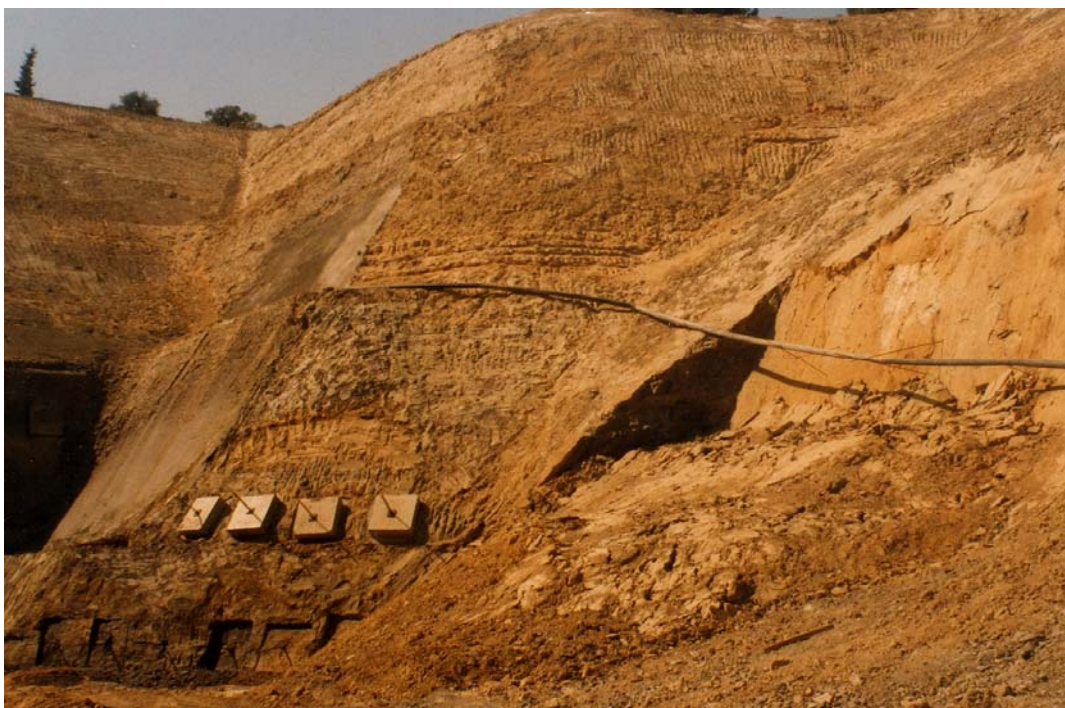
Figura V.11 – Aspecto da falha a poente do encontro sul da Ponte 25 de Abril – vista de norte para sul (fotografia de C.VILAR).
