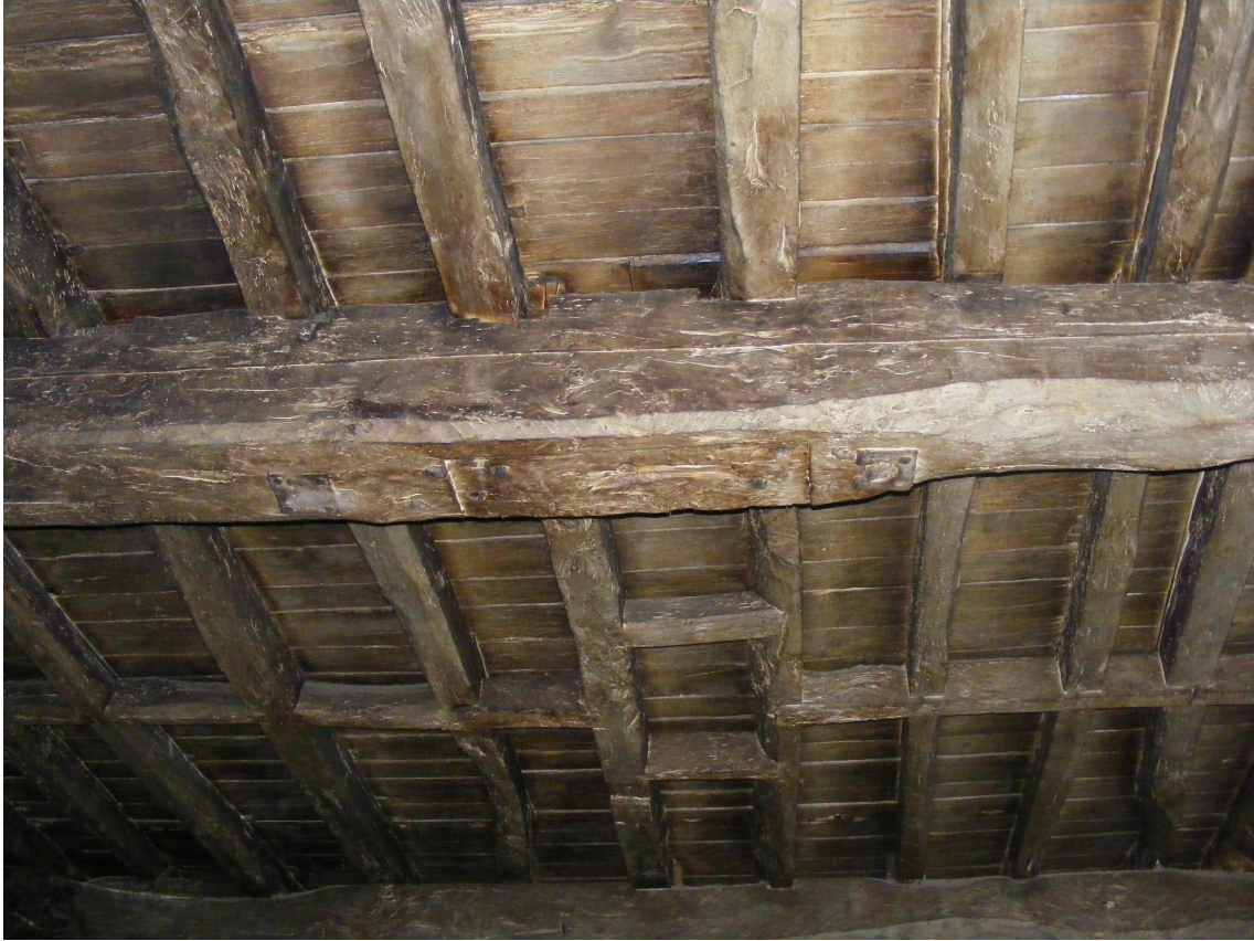
Fig. 40 – Marcas de suportes no travejamento do tecto
