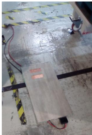
Figura 55 - Placas de cobre para carregamento de AGV's
