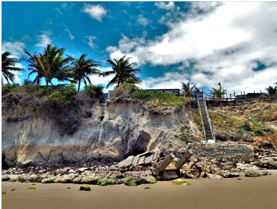
Imagem 17: Erosão na linha de Costa na Praia de Jacumã, Conde/PB, Brasil. Detalhe para a desabamento das arribas em razão da erosão marinha. 28 de novembro de 2015
