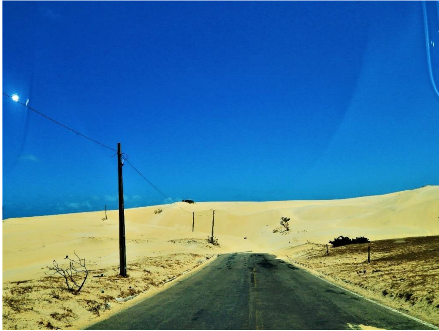
Paracuru/CE. Soterramento de estrada por Dunas móveis.
