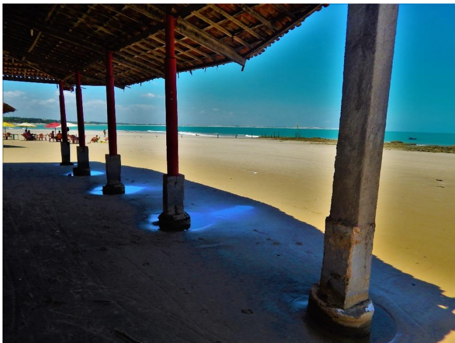
Linha de Costa de Paracuru/CE. Detalhe para destruição exposição das estruturas privadas causada pela erosão marinha.
