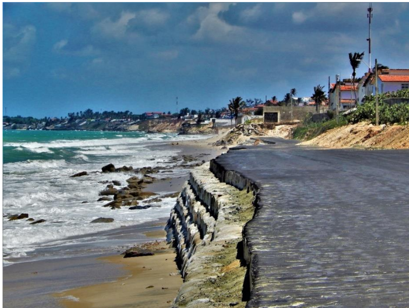
Imagem 06: Erosão marinha na Linha de Costa de Caucaia. Ceará, Brasil. Detalhe para reconstrução de avenida litorânea depois de destruição pela Erosão Marinha e obra de contenção da maré.
