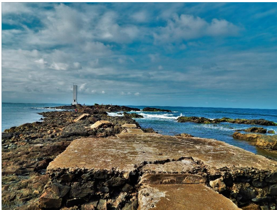
Vista do Farol na Praia da Concha em Itacaré/Bahia. Detalhe para destruição da passarela que permitia a chegada ao farol e servia com espigão para contenção da maré 20 de setembro de 2015.
