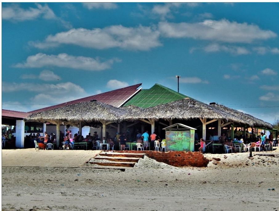
Estabelecimento comercial na Praia de Atalaia em Luís Correia/PI. Detalhe para danificação em parte da estrutura por causa da erosão marinha 11 de outubro de 2015
