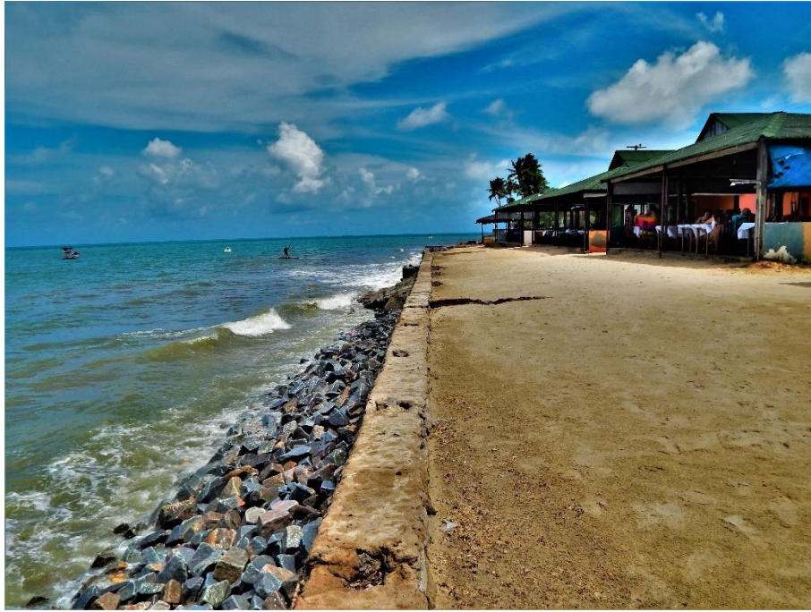
Imagem 18: Erosão Marinha na Linha de Costa da Praia de Muriú, Ceará Mirim/RN, Brasil. Detalhe para obra de contenção da maré. 20 de janeiro de 2016.
