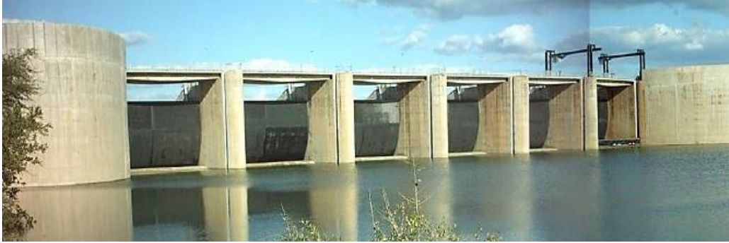
Figura 2.8 - Descarregador de cheias (LNEC, 2011).
