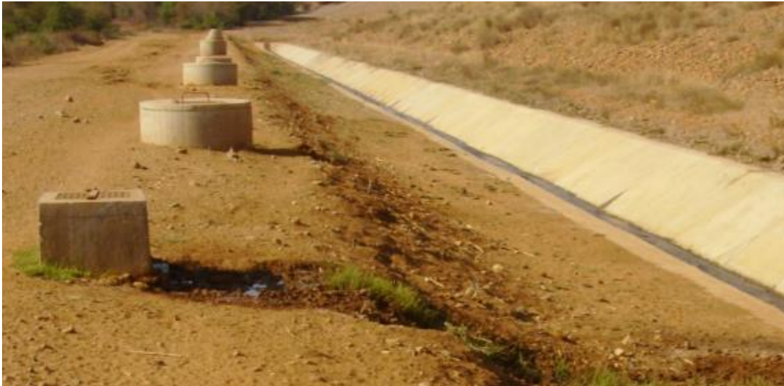
Figura D.6.5 - Aparecimento de água que sai do piezômetro (arquivo pessoal de Eng° João Marcelino).
