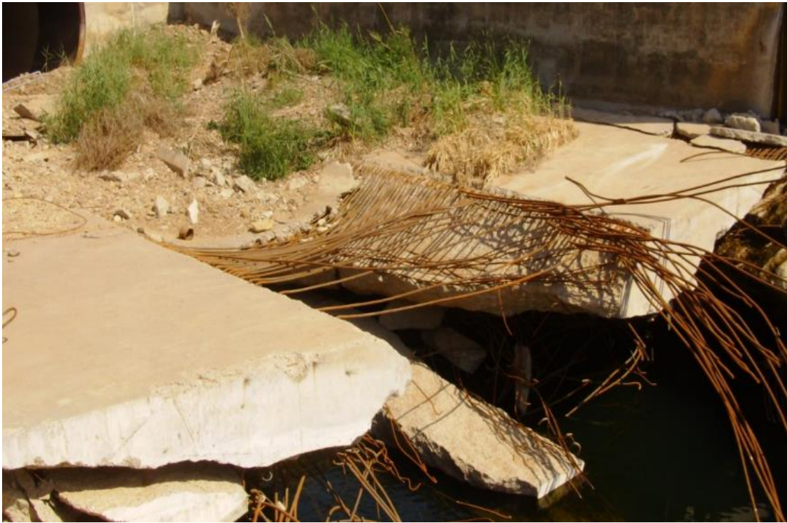
Figura D.6.7 - Descarga de fundo após o acidente de 2008 (arquivo pessoal de Engº João Marcelino)
