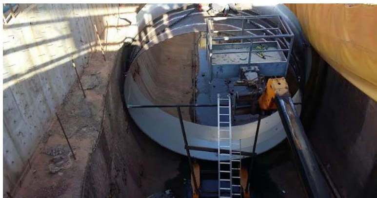
Figura 2.25 - Colocação de um liner de aço na conduta da descarga de fundo (arquivo pessoal do Eng o Óscar Sibia).
