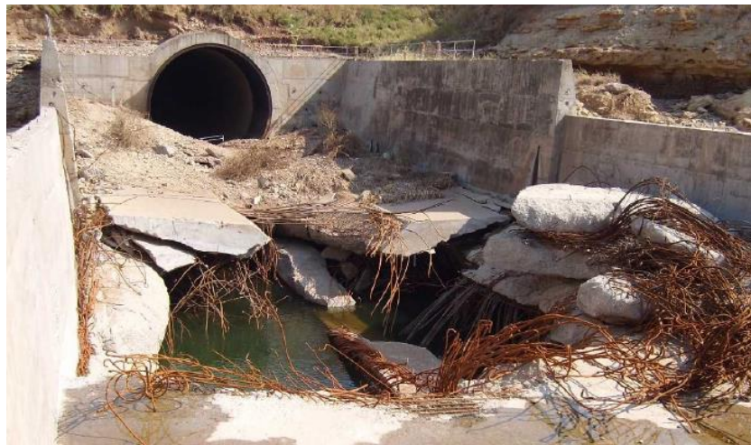
Figura 2.21 - Descarga de fundo do lado de jusante (Portefólio pessoal do Engº João Marcelino, 2010).
