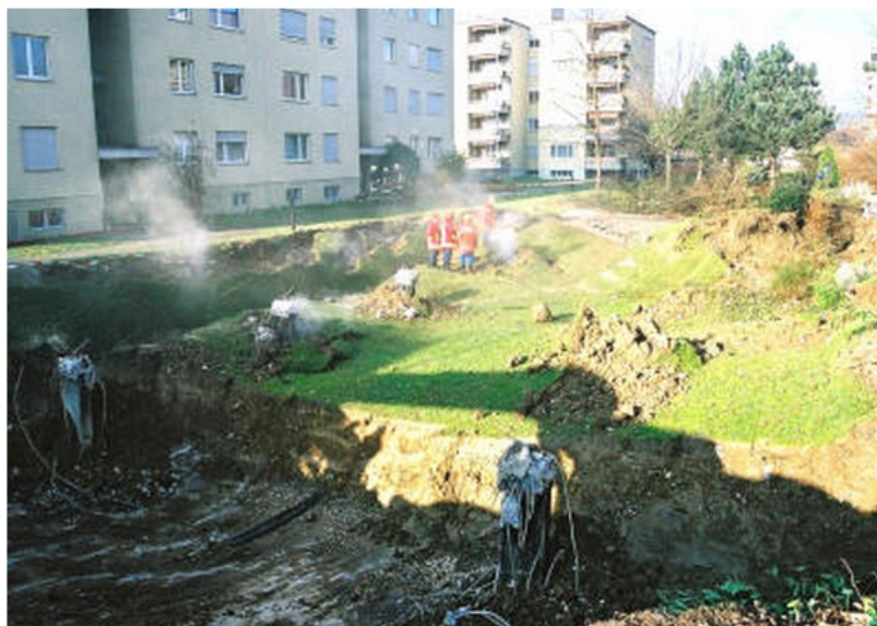
Figura 2.5 – Parque de estacionamento subterrâneo de Gretzenbach após colapso. Ruiz et al (2010).
