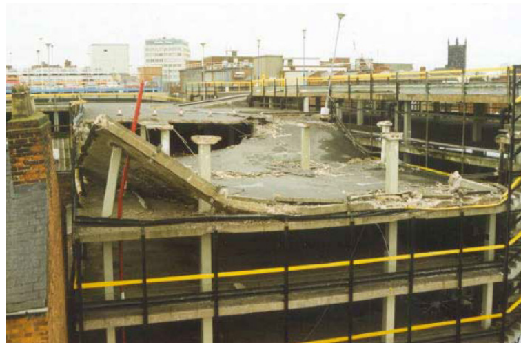
Figura 2.4 – Pipers Row Car Park após colapso da laje do topo, Wood (2001).
