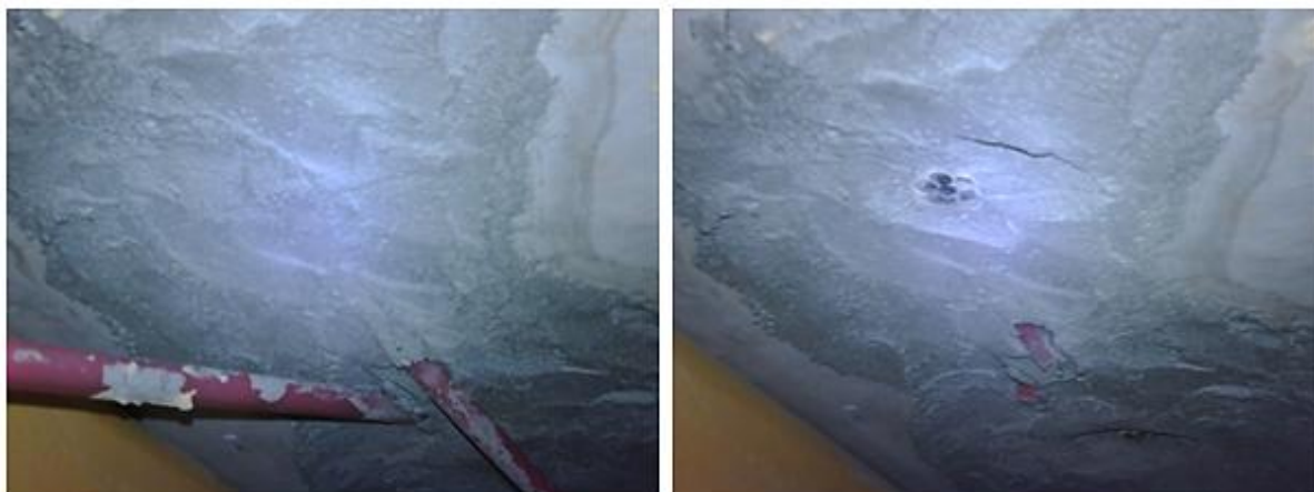
Fig. 113 - Aspecto inicial da face inferior dos blocos (esq.) e face da ancoragem depois de desbastada (dta.)
