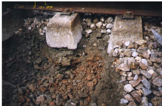
Figura 4.19 - Desgaste da fundação por balastro muito contaminado, adaptado (Fortunato, 2005)
