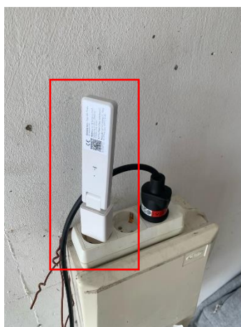
Figura 3.10 - DTU utilizada para a monitorização da produção fotovoltaica.
