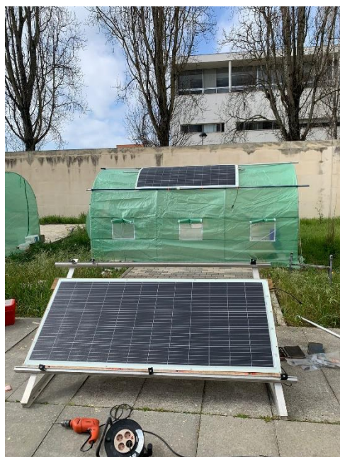
Figura 3.9 – Fotografia da instalação fotovoltaica.
