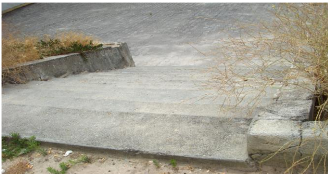
Fotografia 50 – separação dos dois bairros Arneiros e IGAPHE - pormenor das escadas de acesso
