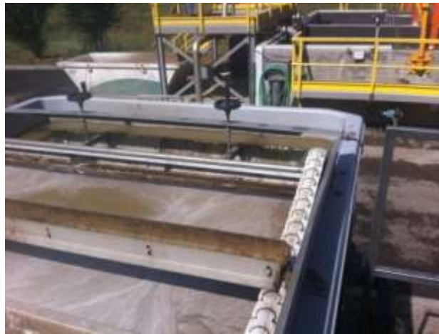
Figura 35 -Tanque de Flotação. (Fonte: Querido, D. 2015)
