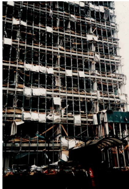
Figura 1.2: Danos extensivos no revestimento em Docklands, Londres [31].
