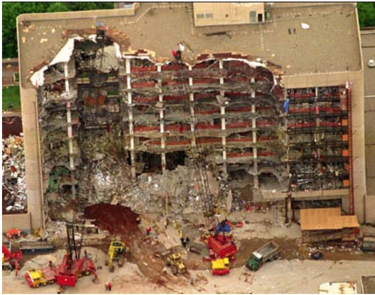
Figura 1.1: Destruição do edifício federal em Oklahoma City [31].
