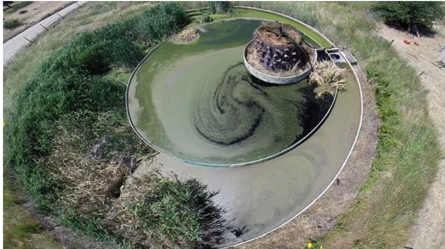
Figura 4.26 – Sistema de tratamento biológico das águas cinzentas no recinto do Boom Festival (AGF, 2014)
