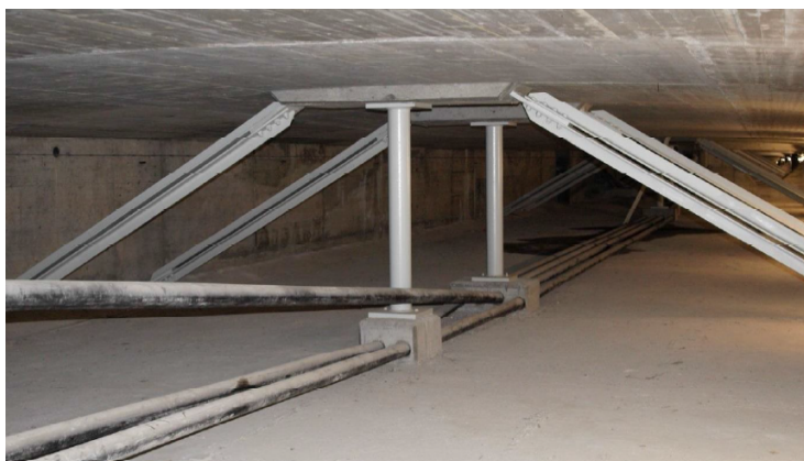
Figura 3.4: Cabos de pré-esforço exterior e tirantes metálicos no interior do tabuleiro
