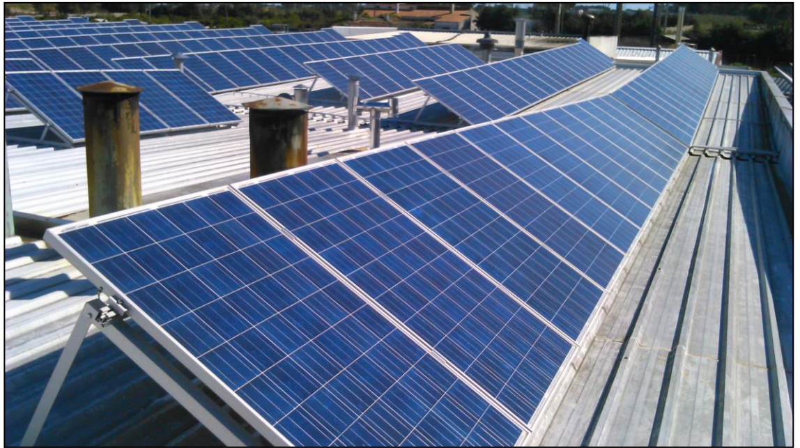
Figura 8 - Painéis na instalação fotovoltaica em estudo
