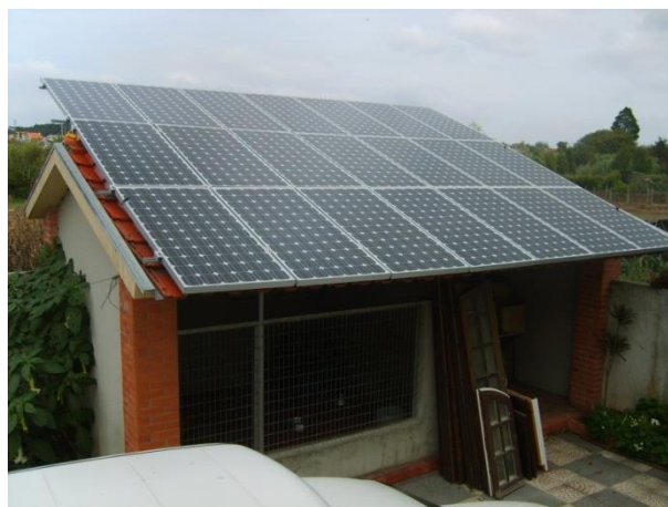
Figura 3.6 – Integração de fotovoltaico no telhado da casota do cão numa vivenda em Aveiro
