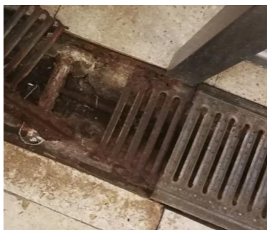
Figura 3.4 - Grelhas e ralo de escoamento de água
