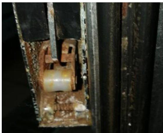
Figura 3.5 - Maçaneta do equipamento de frio em mau estado
