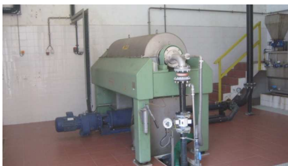
Figura 3.15 - Centrífuga Westfalia instalada na ETAR de Fátima
