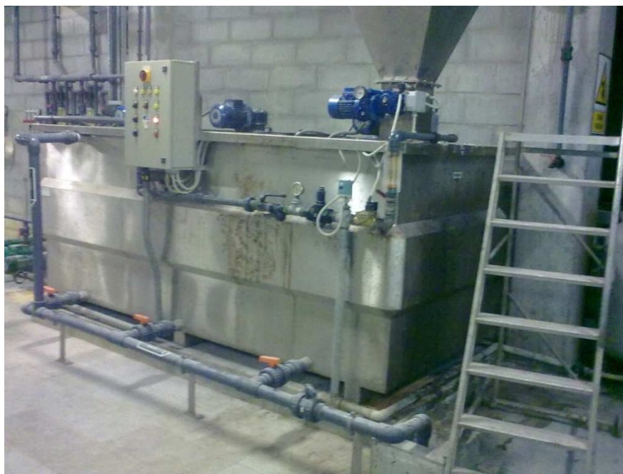
Figura 3.20 - Unidade de preparação de polímero da ETAR de Setúbal
