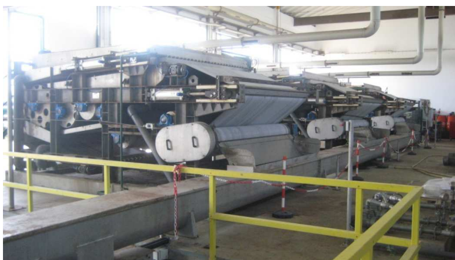
Figura 3.10 - Filtros banda Andritz instalados na ETAR Norte da SIMRIA
