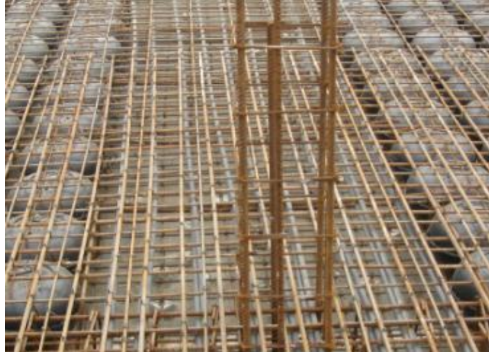
Figura 2.3 - Laje aligeirada pós-tensionadas (Luanda 2012)
