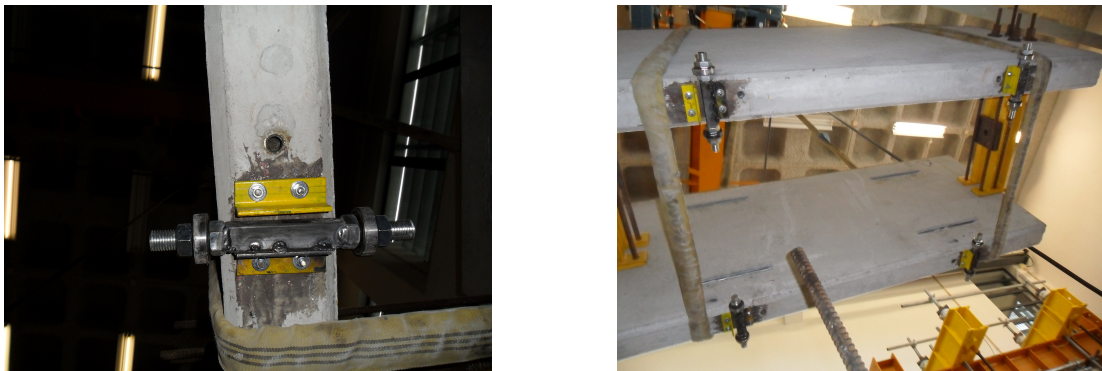
Figura 3.8: Sistema de rolamentos aplicados na base dos painéis
