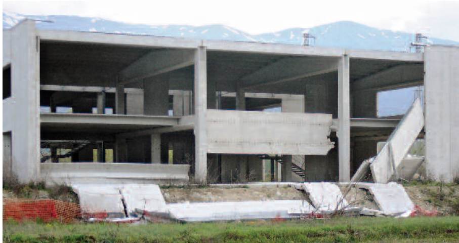
Figura 1.1: Edifício pré-fabricado em construção, onde os painéis de fachada colapsaram durante o sismo [13]
