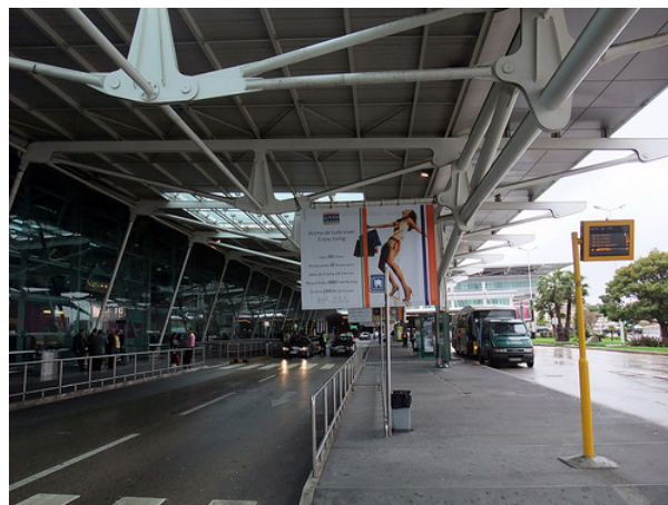
Figura 2.2: Pormenor da cobertura do gare de chegadas do Aeroporto Internacional de Lisboa.
