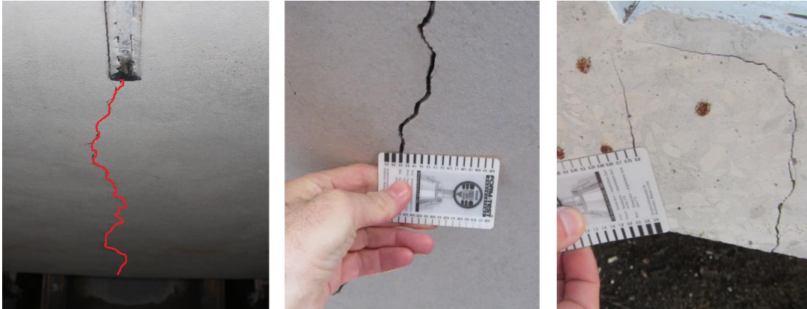
Figura 4.11- Fendilhação por flexão a meio vão na placa de referência
