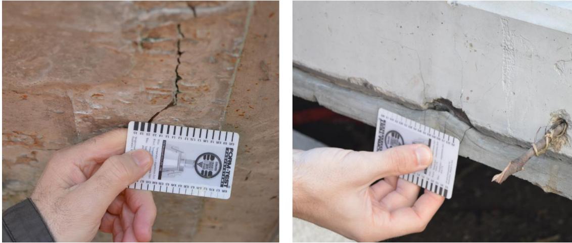
Figura 4.10- Fendilhação por flexão a meio vão na placa B
