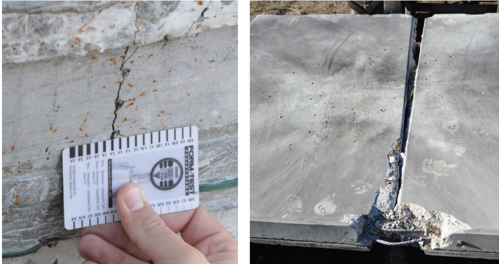
Figura 4.8- Medição de abertura de fendas e esmagamento do betão na laje C
