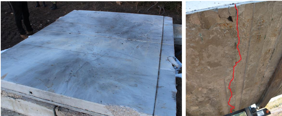
Figura 4.9- Fendilhação na laje B
