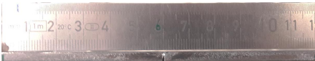
Figura 3.49- Pormenor do defeito presente na viga 2-B
