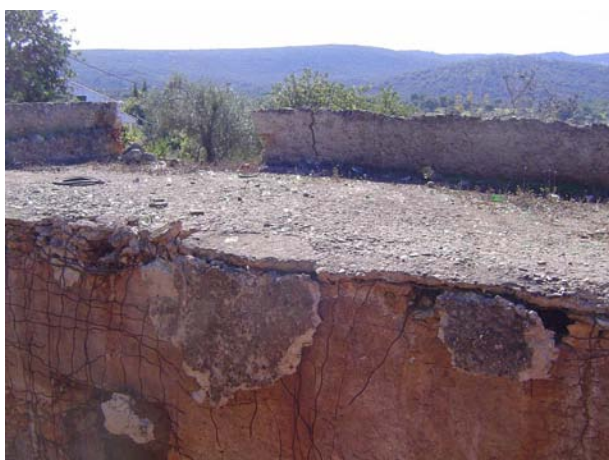
Fig 3.117 – Acabamento superior da cobertura, sem aplicação de revestimento sobre a laje.
