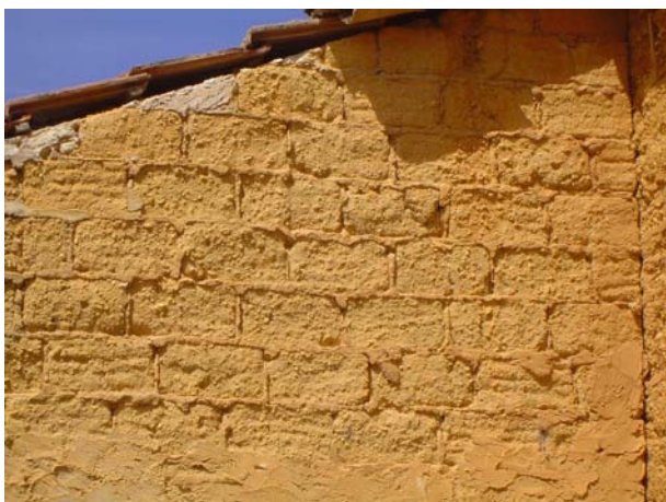
Fig 3.13 – Parede interior em adobe, actualmente sem cobertura.
