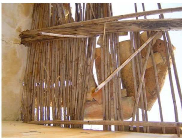
Fig 3.83 – Rotura de barrote da cobertura, com queda das canas e telhas.
