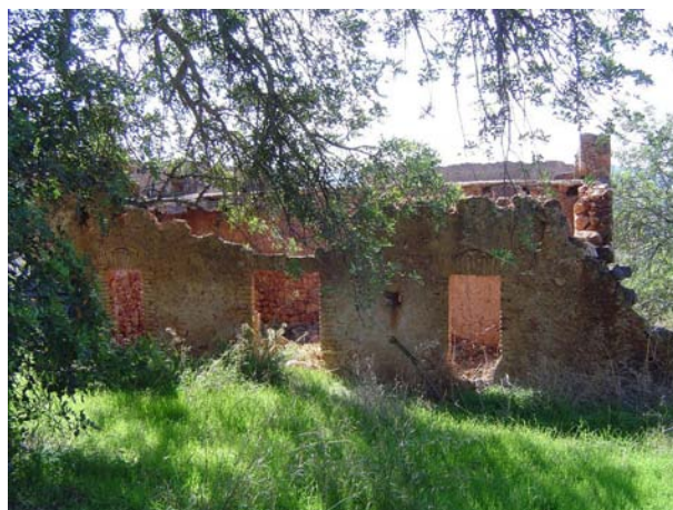
Fig 3.94 - Fachada de tardo virada a Norte, visivelmente em ruína.
