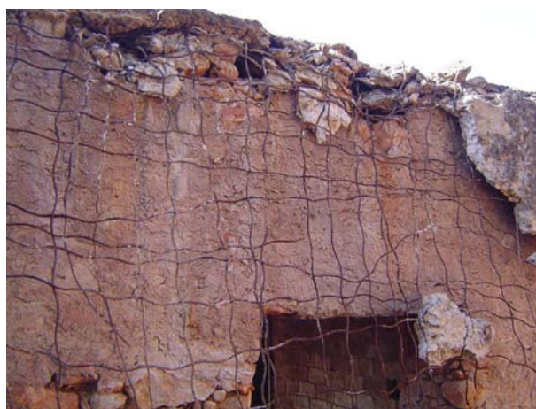
Fig 3.116 – Degradação da laje, verificando-se a geometria da malha de aço.
