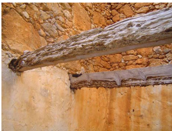
Fig 3.79 – Encontro degradado devido à acumulação de humidade e fraca ventilação.
