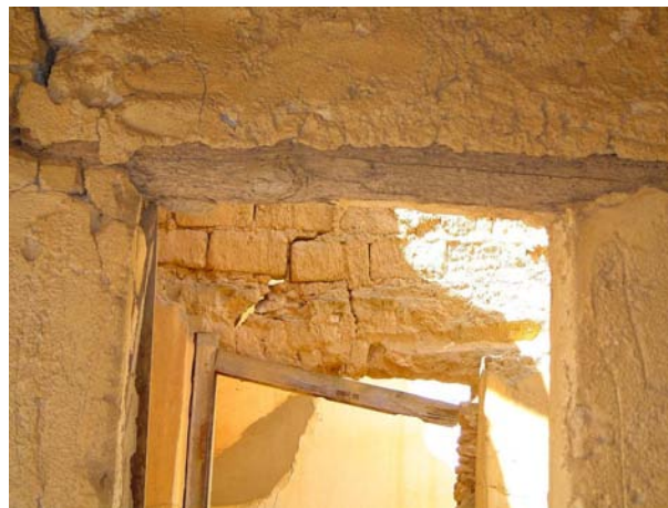
Fig 3.28 – Degradação de vergas interiores em madeira.
