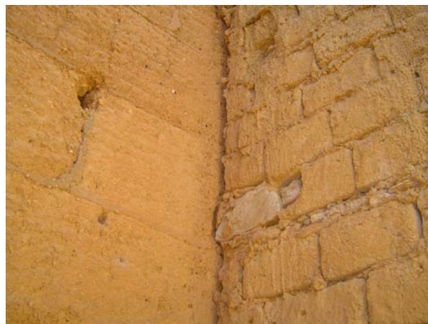
Fig 3.26 - Destacamento entre parede interior de taipa e adobe.
