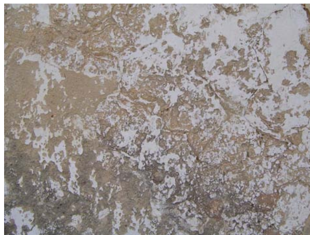
Fig 3.70 - Fissuração do revestimento, com degradação da caiação.
