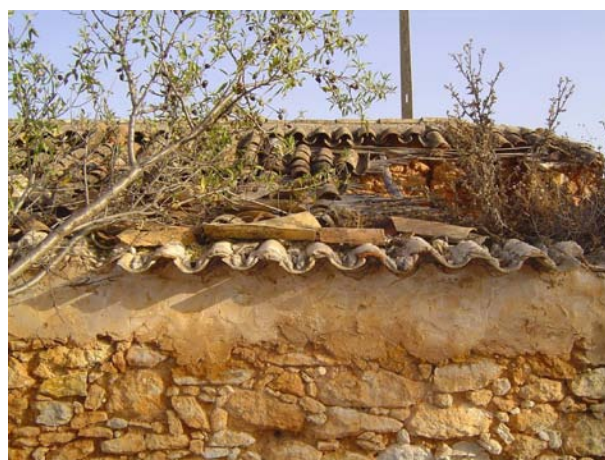
Fig 3.84 – Degradação geral da estrutura em madeira da cobertura.
