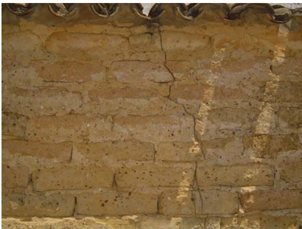
Fig 2.23 – Parede exterior em adobe, não revestida, com fissura.
