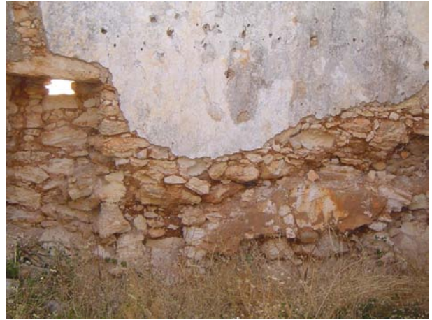
Fig 3.66 - Fachada em pedra não aparelhada, com degradação da argamassa de revestimento.
