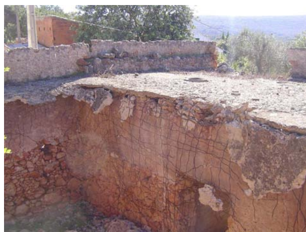
Fig 3.118 – Vista geral da queda da cobertura, na parte traseira da edificação.
