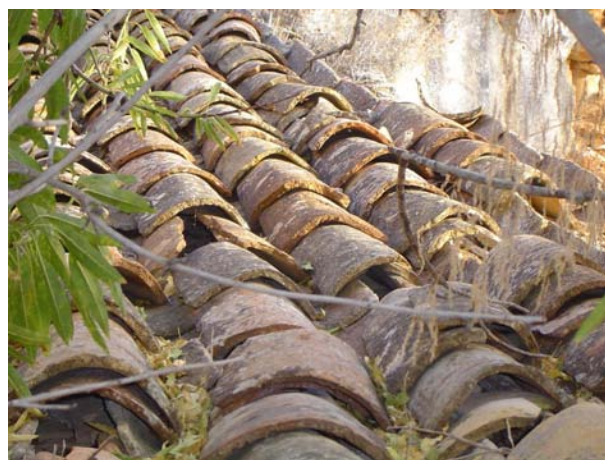
Fig 3.82 - Aspecto exterior da cobertura, com algumas telhas partidas.
