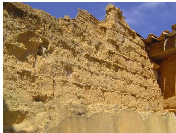
Fig 3.14 – Parede interior em adobe, bastante degradada no topo.
