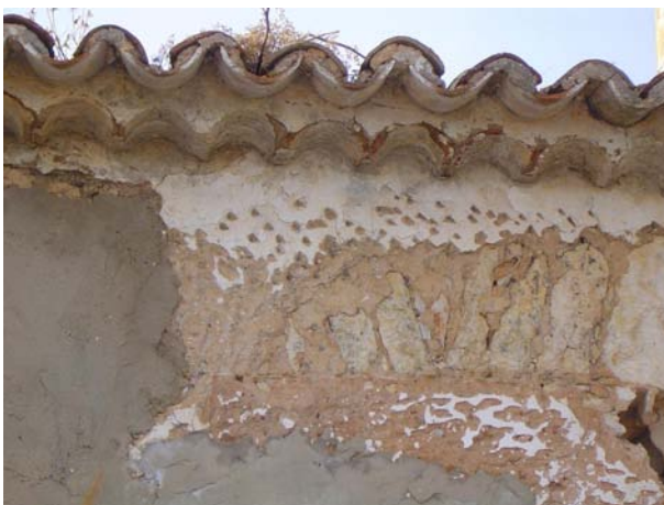
Fig 3.67 - Heterogeneidade do revestimento da fachada, aplicado em diferentes épocas.
