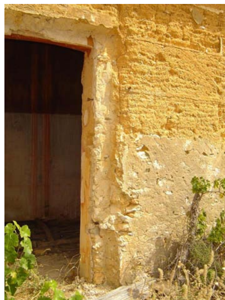
Fig 3.30 - Vão exterior com destacamento das cantarias da verga e ombreiras.
