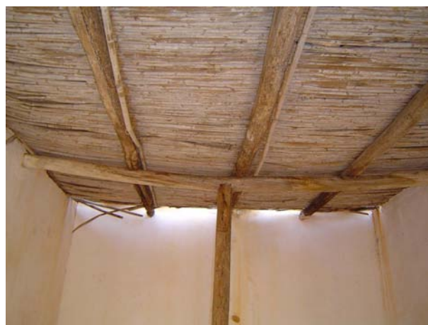
Fig 3.78 – Elemento de escoramento dos barrotes, devido à sua elevada flecha.
