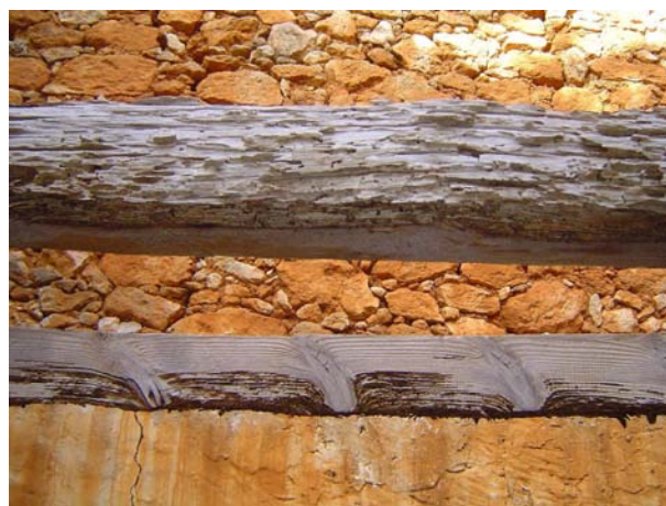
Fig 3.80 – Perda de secção na madeira, causada por agentes biológicos.
