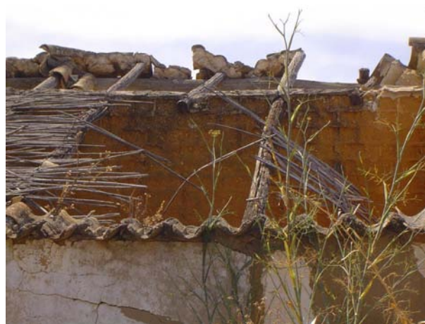
Fig 3.38 – Degradação dos barrotes, com queda da esteira de canas e das telhas canudo.
