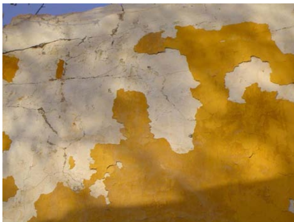
Fig 3.69 - Destacamento da pintura amarela da cozinha, sendo visível a cor inicial branca.
