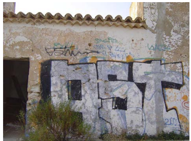
Fig 3.68 – Fachada principal, com degradação provocada pelo Homem através de graffitis .
