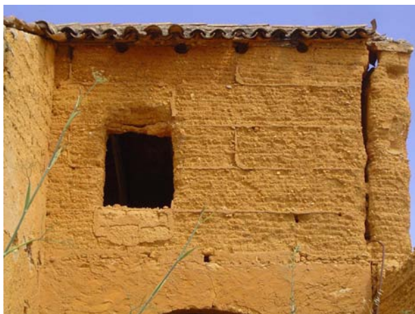
Fig 3.25 - Destacamento entre parede exterior e interior, na fachada Nordeste.
