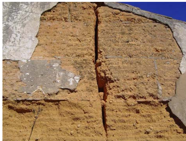
Fig 2.26 – Fissuração em parede de taipa, com atravessamento dos blocos.
