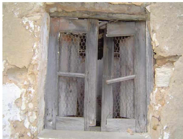
Fig 3.72 – Vão da fachada principal com rede, sem vidro.
