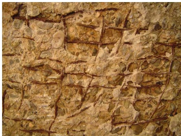
Fig 3.120 – Destacamento do recobrimento, ficando à vista a malha de aço.
