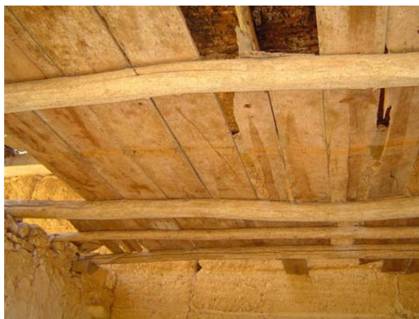
Fig 3.46 – Estrado de madeira, com alguma degradação dos barrotes e das tábuas.
