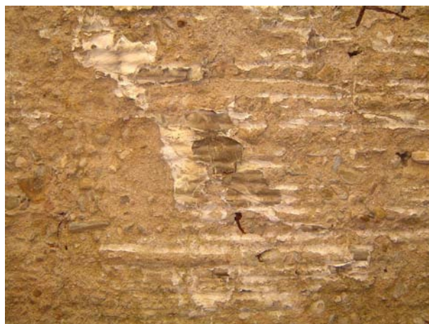
Fig 3.122 – Textura das sacas de cimento e da esteira, no tecto do quarto.
