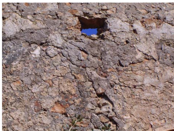
Fig 3.108 – Fissuração e acumulação de vegetação parasitária, junto à abertura.
