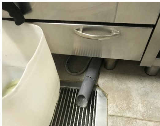
Figura 3.12- Ralo da zona de confeção em deficiente estado de conservação
