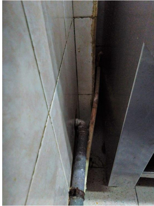
Figura 3.8- Zona de armazenamento em mau estado
