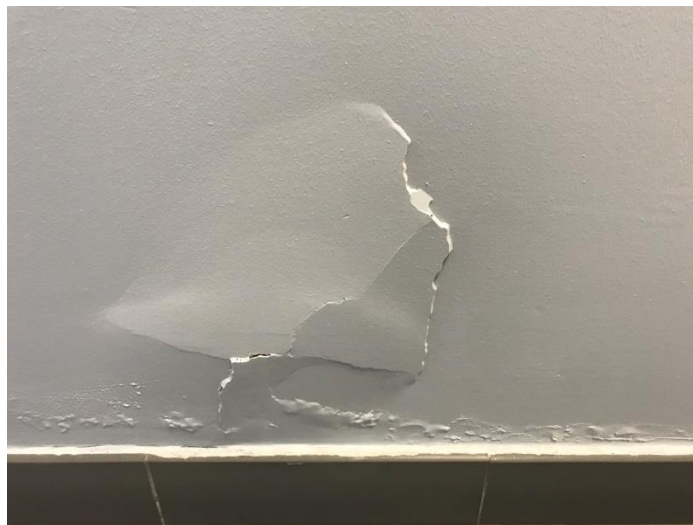
Figura 3.21- Degradação da parede de um corredor técnico
