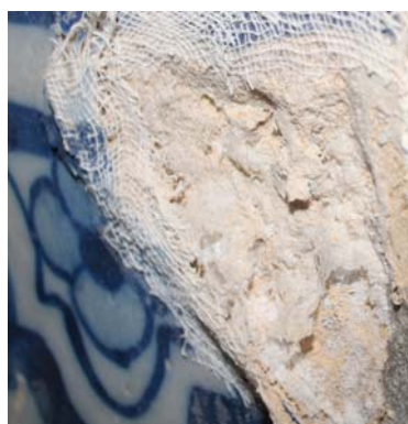
Figura 3.8. Pormenor de outro painel do mesmo edifício do Ecomuseu em que se evidencia a presença de sais solúveis.
