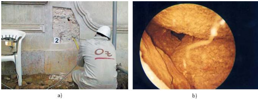
Figura 20 - Ensaio com boroscópio; a) Observação boroscópica de uma parede; b) Imagem boroscópica do interior de uma parede de alvenaria (Oz - diagnóstico, levantamento e controlo da qualidade em estruturas e fundações, Ida., 2007).
