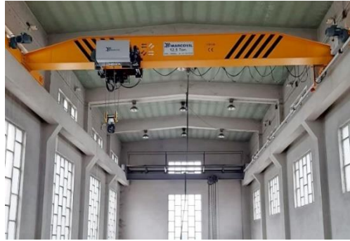
Figura 5.23- Ponte rolante univiga da empresa Marco Vil [24]
