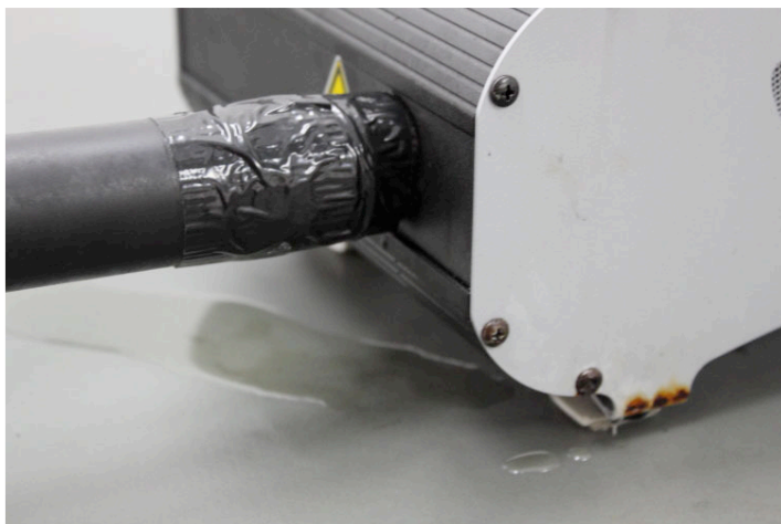
Fig. 82 - Ligação tubo “T” com a máquina de fumo DTS FX-5. (escorrimento de líquido).
