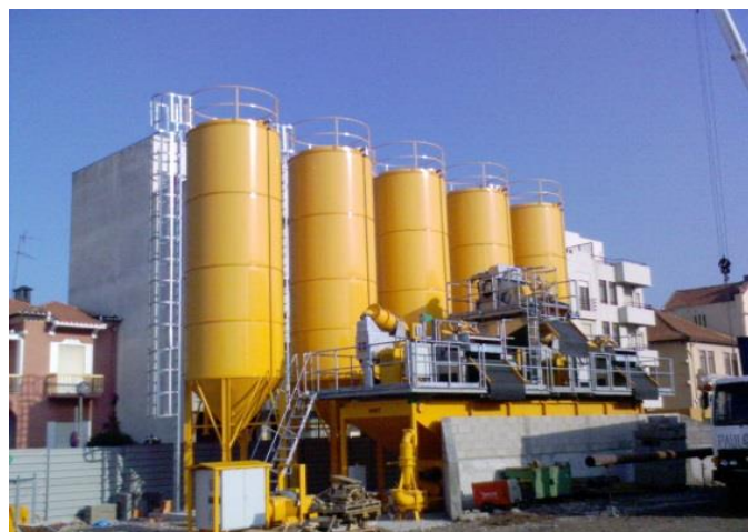
Figura 1.2 – Enquadramento da central de bentonites para a hidrofresa de Espinho
