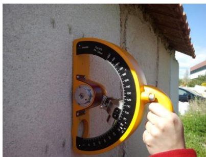
Figura 5.43 – Esclerómetro pendular aplicado no reboco
