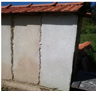
Figura 6.36 – Aspeto visual dos dois rebocos aplicados no murete de taipa (aos 90 dias): argamassas CL3_10t(ArF) e CL3
