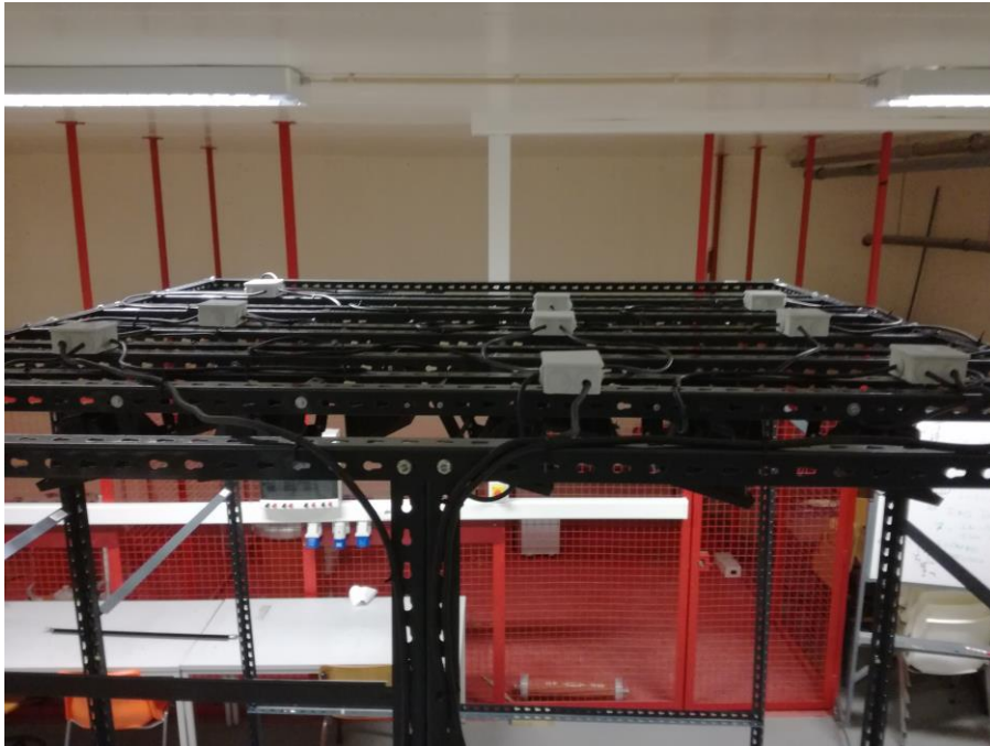
Figura 3.30 - Ligação das luminárias às caixas de derivação.
