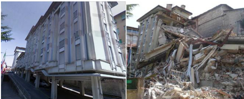
Figura 2.4 - Hotel Duca degli Abruzzi, Antes e Depois, L'Aquila, efeito "soft storey" amplificado pela diferença de cotas no mesmo piso [6].
