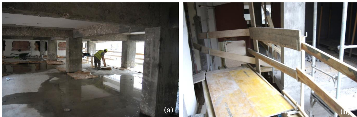
a - Presença de água pode originar eletrocussões ; b - Plataforma entre dois caminhos de circulação diferentes
