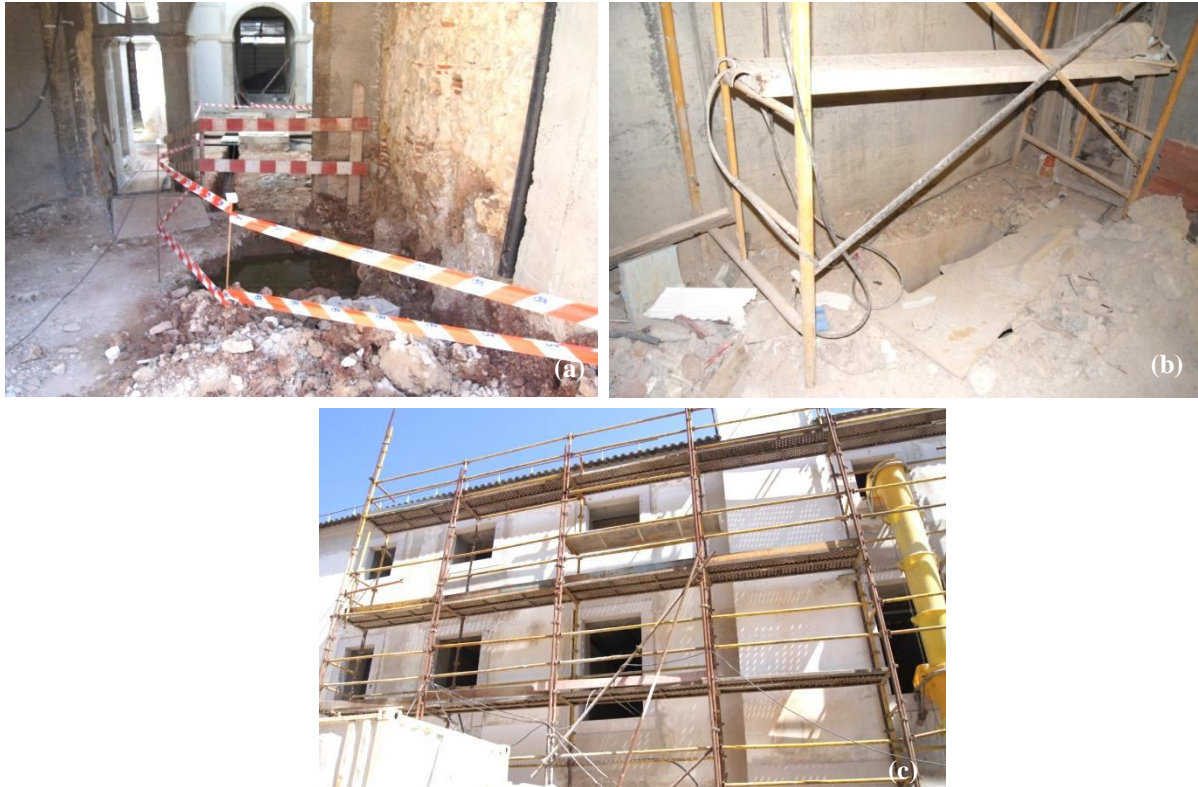
a - Falta de guarda-corpos sólido ; b - Negativo não protegido ; c - Existência de deficiências nos andaimes
