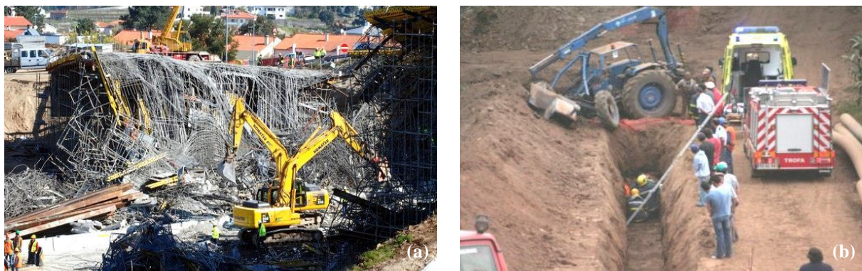
a - Queda de estrutura de viaduto ainda na fase da sua execução (Site "Sic Notícias") ; b - Capotamento de máquina e posterior queda de trabalhador numa vala (Site "Epralima")
