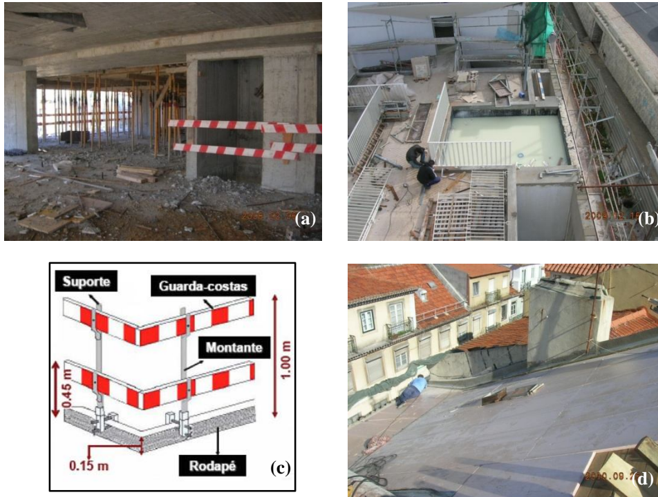
a - Falta de rodapé na caixa de elevador e de limpeza (cedida pelo Eng. Jorge Leal) ; b - Falta de guardas e alguma desarrumação limpeza (cedida pelo Eng. Jorge Leal) ; c - Sistema de guarda-corpos rígido (Site “Dashofer”) ; d - Falta de linha de vida e de guardas limpeza (cedida pelo Eng. Jorge Leal)
