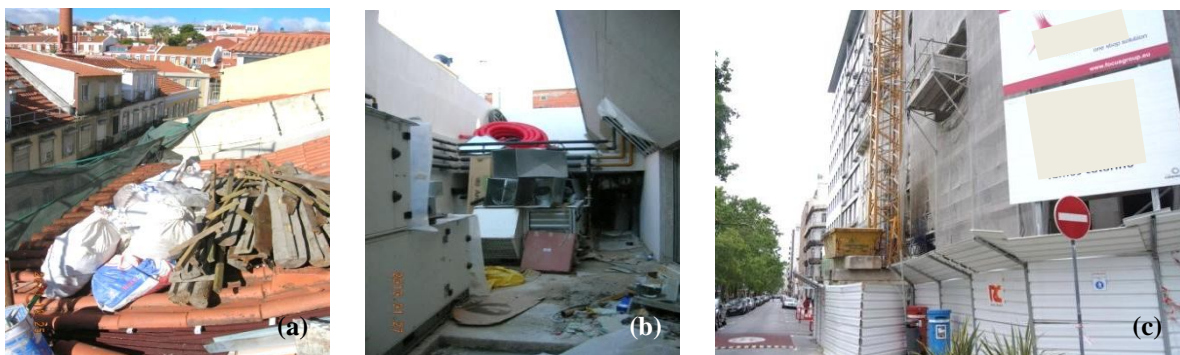
a,b - Problemas de limpeza (cedidas pelo Eng. Jorge Leal) ; c - Mau posicionamento do contentor
