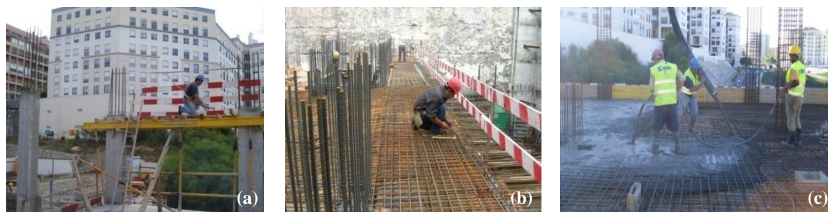
a - Início do processo de execução do escoramento e cofragem ; b - Trabalho da colocação de armaduras (cedida pelo Eng. Jorge Leal) ; c - Betonagem de laje
