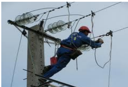
Figura 2.12 - Exposição a riscos elétricos e a quedas em altura em atividades da construção (Blog “Notícias dos Açores”).
