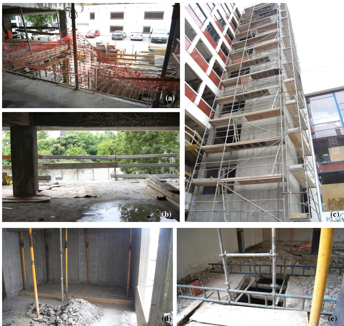
a - Falta de guarda-corpos sólido ; b - Falta de rodapé ; c - Deficiências nos alçapões dos andaimes ; d - Proteção da caixa de elevadores ; e - Falta de proteção de negativo
