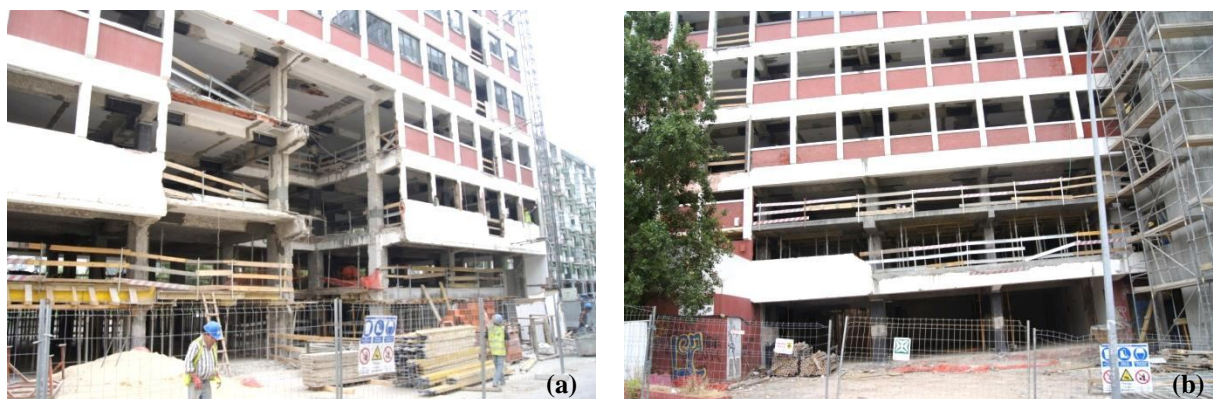
a - Vista de parte da fachada principal ; b - Vista de parte do tardoz
