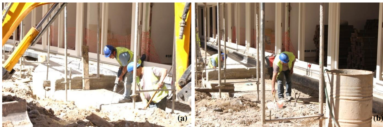
a - Utilização de protetores auriculares ; b - Falta de utilização de luvas e de protetores auditivos
