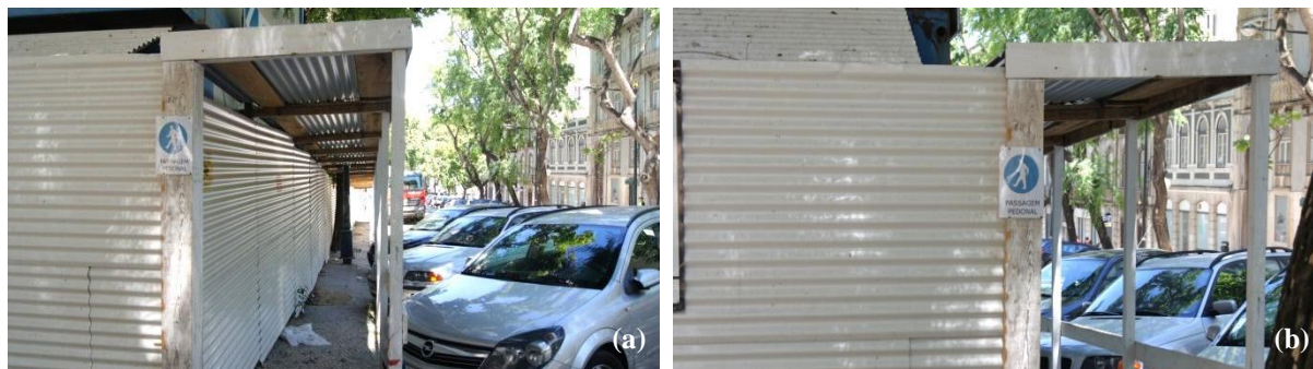
a - Passadiço de proteção de peões ; b - Sinalização de encaminhamento de peões
